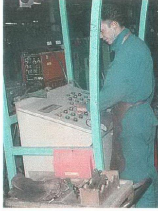
Şekil 9.3 Şekil 9.1 ve Şekil 9.2’de gösterilen fikstürün PLC kontrol ünitesi (Mercedes Benz Türk A.Ş. fabrikası)
