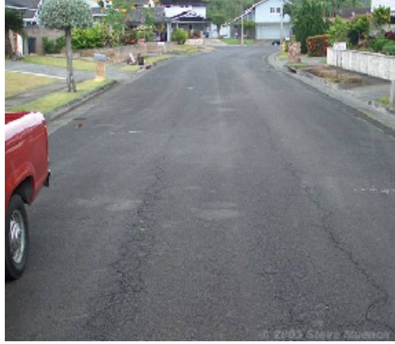
Şekil 4.7 Derz çatlakları (URL -1, 2007)
