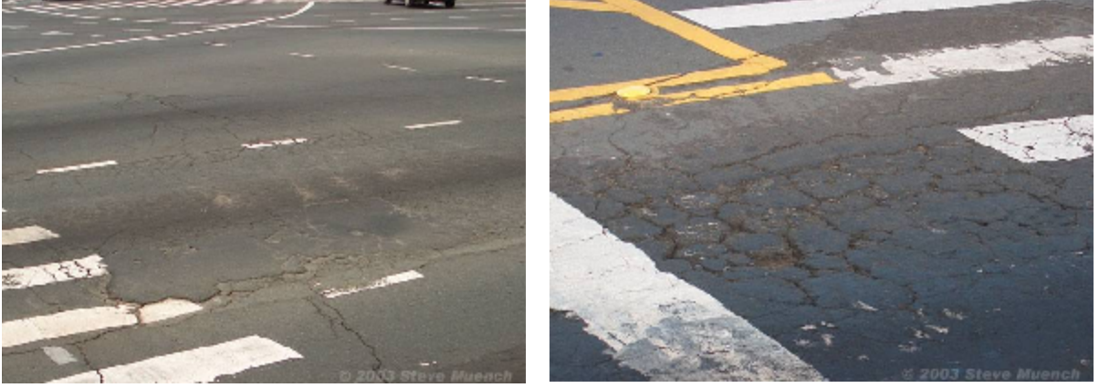
Şekil 4.5 Yorulma çatlakları (URL -1, 2007)
