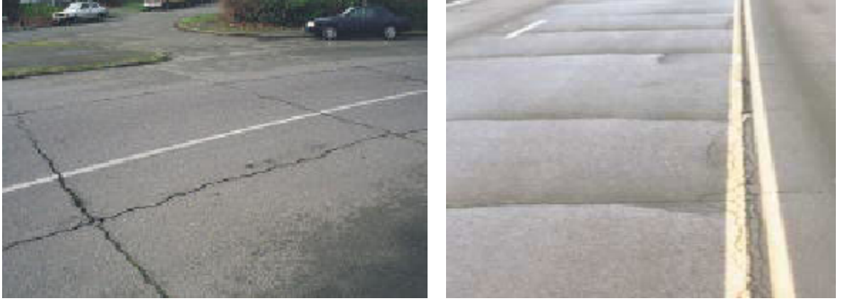
Şekil 4.9 Yansıma çatlakları (URL -1, 2007)
