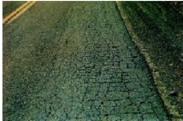
Şekil 4.4 Timsah sırtı çatlakları (URL -2, 2007)
