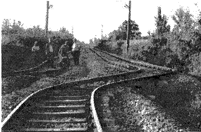
Şekil 3.5 1999 Gölcük-Arifiye depremi sonrası demiryolu raylarındaki yanal yer değiştirme
