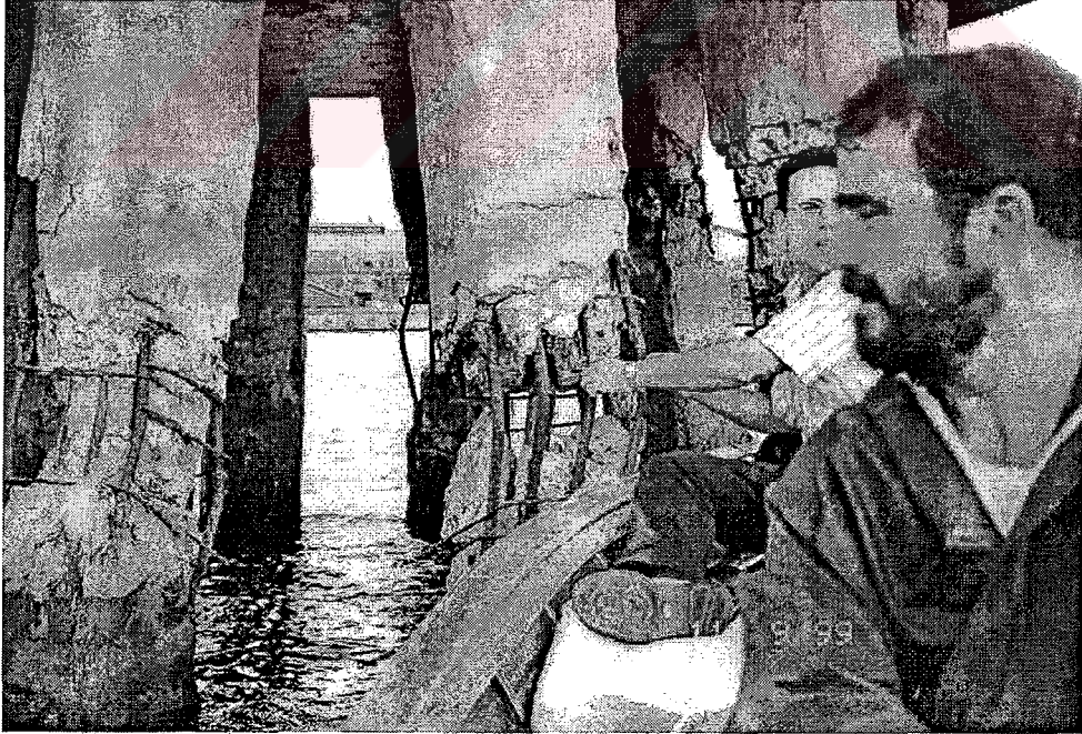
Şekil 4.7 Betonarme elemanın su kotuna yakın bölgesinde korozyon hasarı
