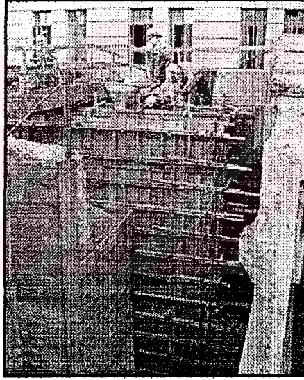
Şekil Ek 3.30 Yan duvarda beton dökülmesi
