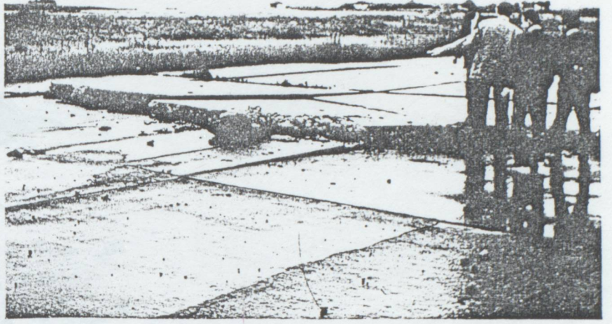
Şekil I.25 Hava alanı yolunda hasar Niigate (1960)
