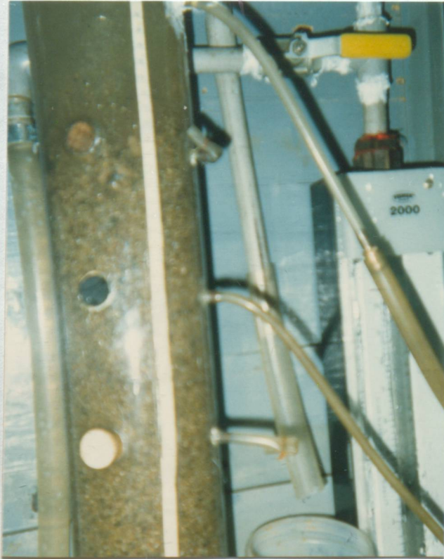
7.3.2. Kum Filtresinin Geri Yıkanması.
