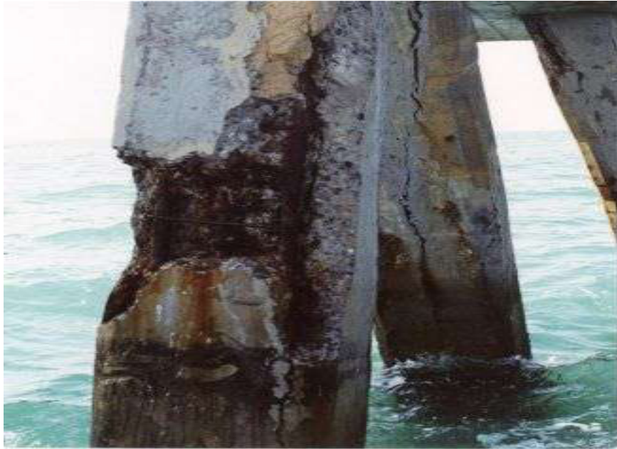
Şekil 5. 2 Bir liman işletmesinin korozyona uğramış yapıları
