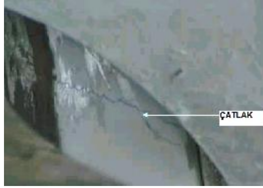
Şekil 6.20 Girdap akımları tekniği ile saptanan çatlak görüntüsü
