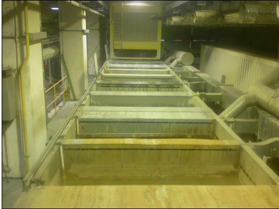
Şekil 2.14 Banyolama tesisinin görüntüsü.
