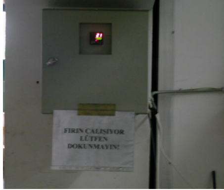
Şekil 5.7 Fırın sıcaklık kontrol ünitesi.
