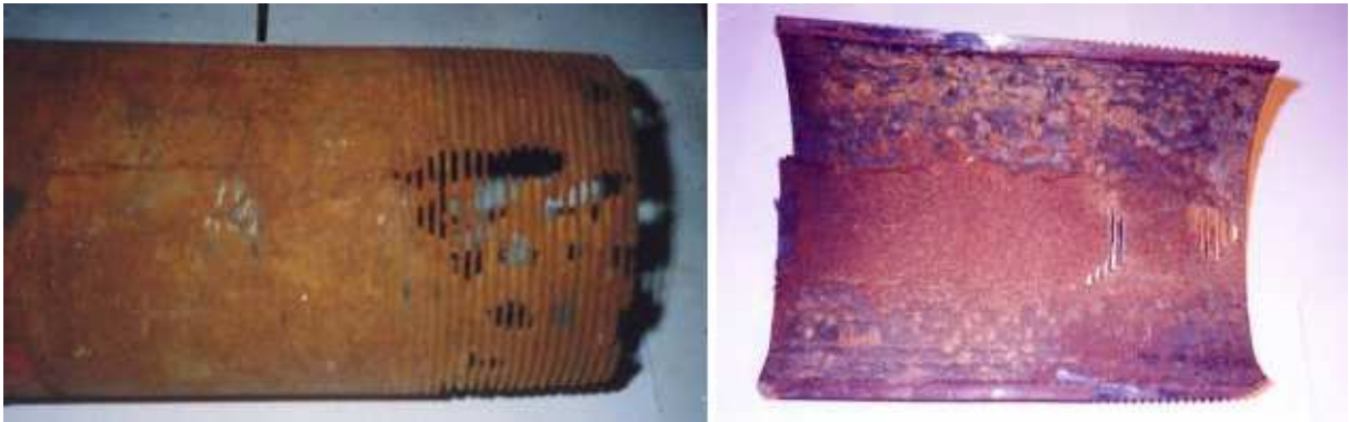
Şekil 2.21 Borunun dış ve iç görünümü ile erozyon korozyonu
