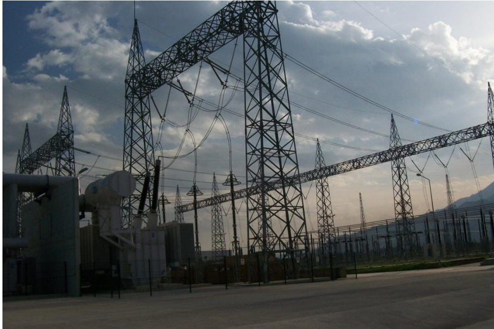
Şekil 8. 8 Gaz türbini step-up transformatörü ve IPB bağlantısı
