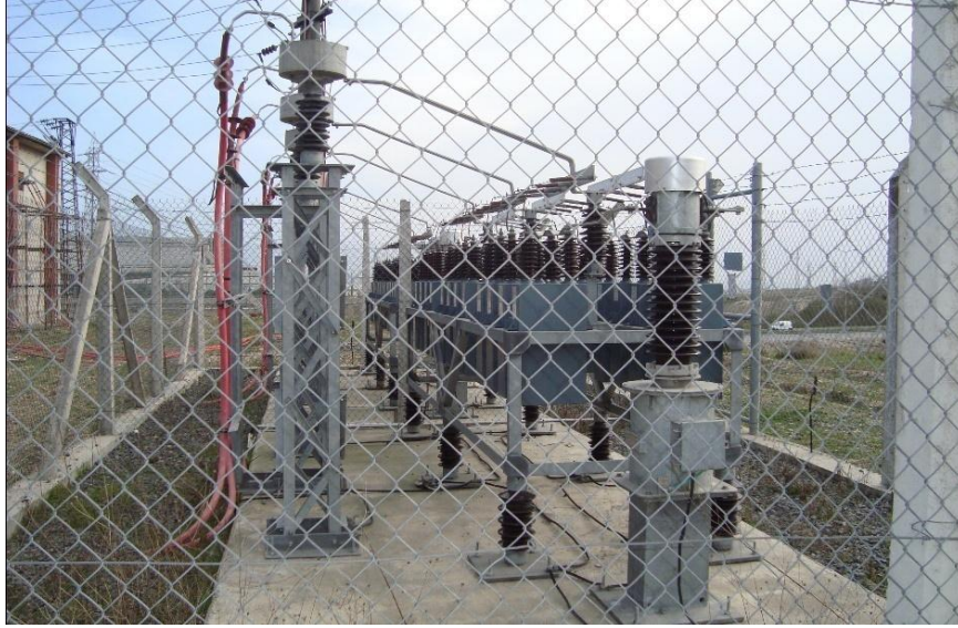
Şekil 4. 5 4800 kVAR' lık kondansatör bankosunun görünümü
