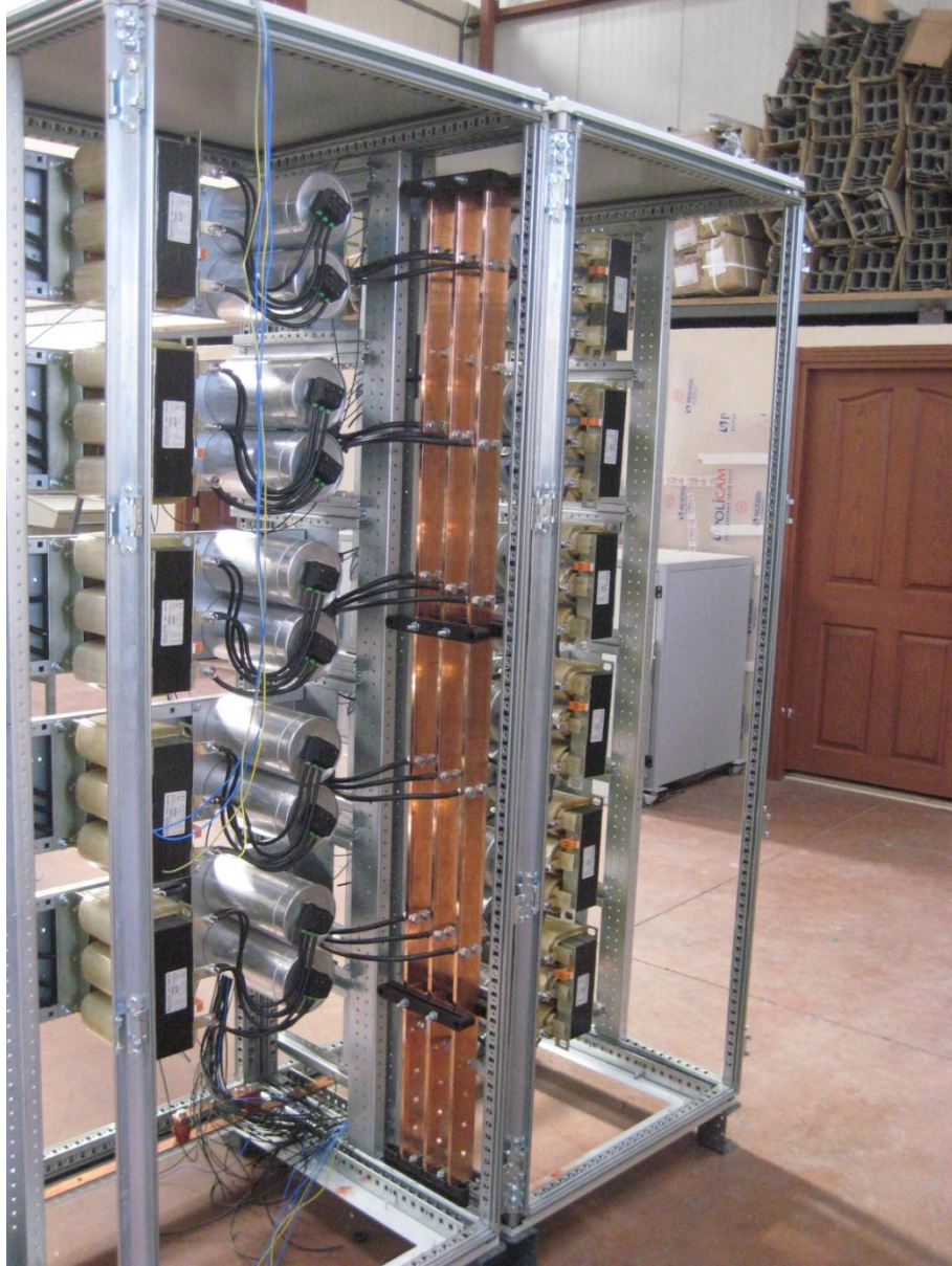
Şekil 3. 41 Harmonik reaktörlü kompanzasyon panosu iç görünüş -3
