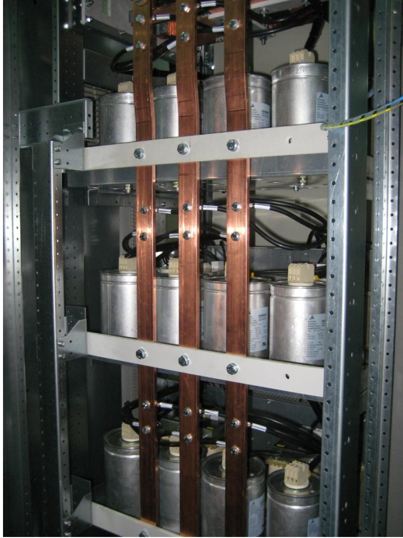
Şekil 3. 11 Kondansatörlerin pano içinde yerleşimi
