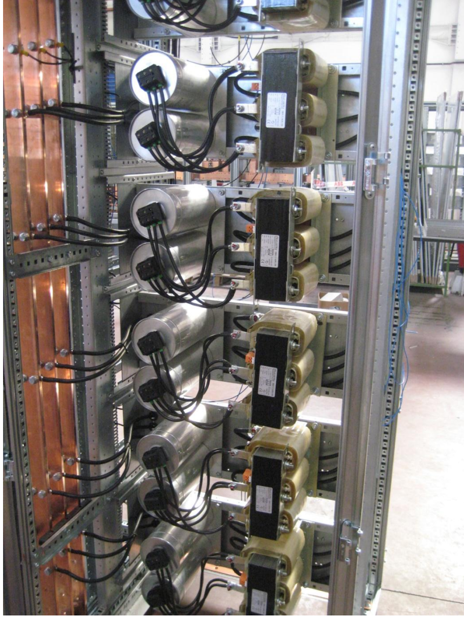
Şekil 3. 40 Harmonik reaktörlü kompanzasyon panosu iç görünüş -2
