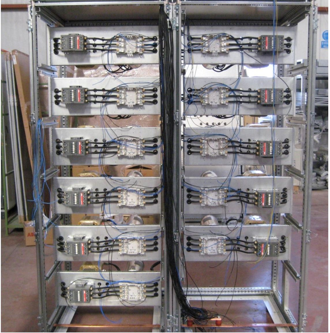
Şekil 3. 39 Harmonik reaktörlü kompanzasyon panosu iç görünüş -1
