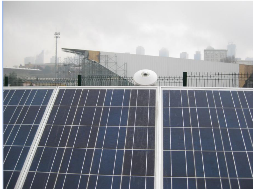
Şekil 4.11 Fotovoltaik paneller için kurulan sistem
