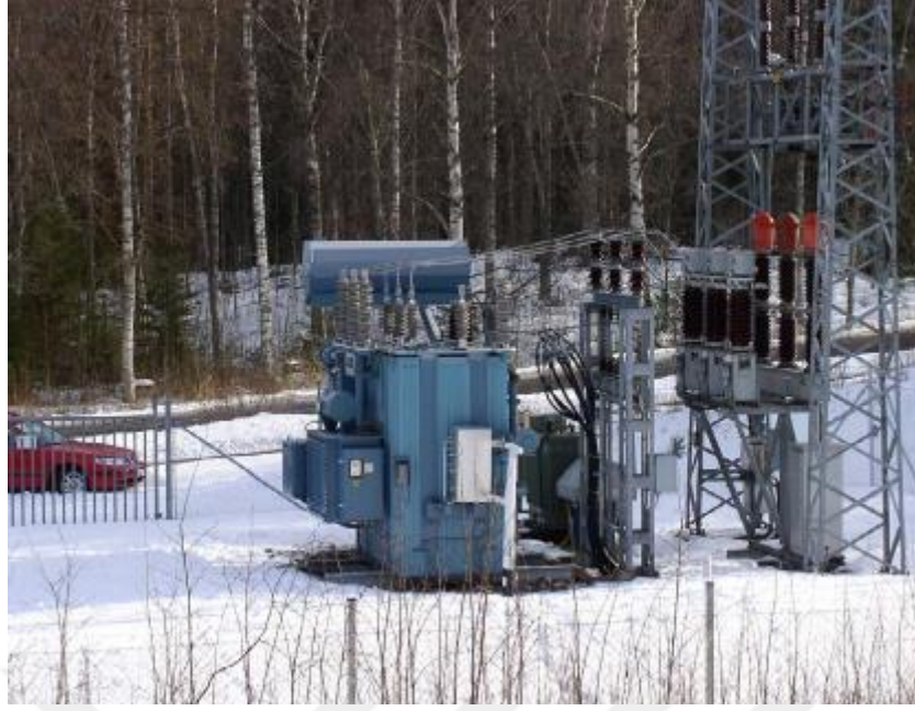
Şekil 4.17 Gürültü ölçümleri yapılan güç transformatörü[41]
