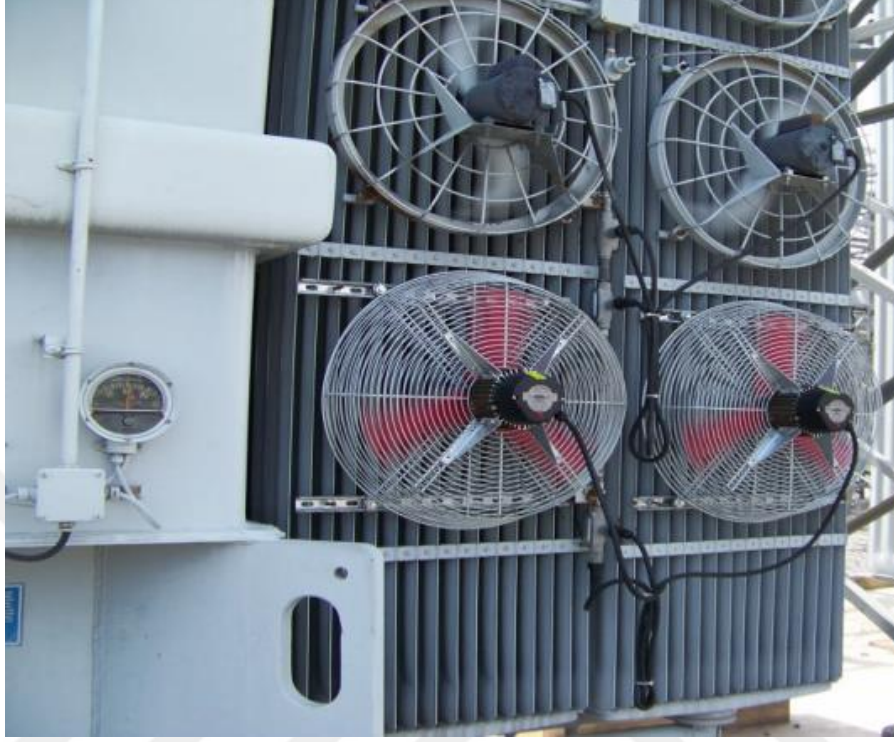
Şekil 3.81 Güç transformatöründe bulunan soğutma fanları[37]
