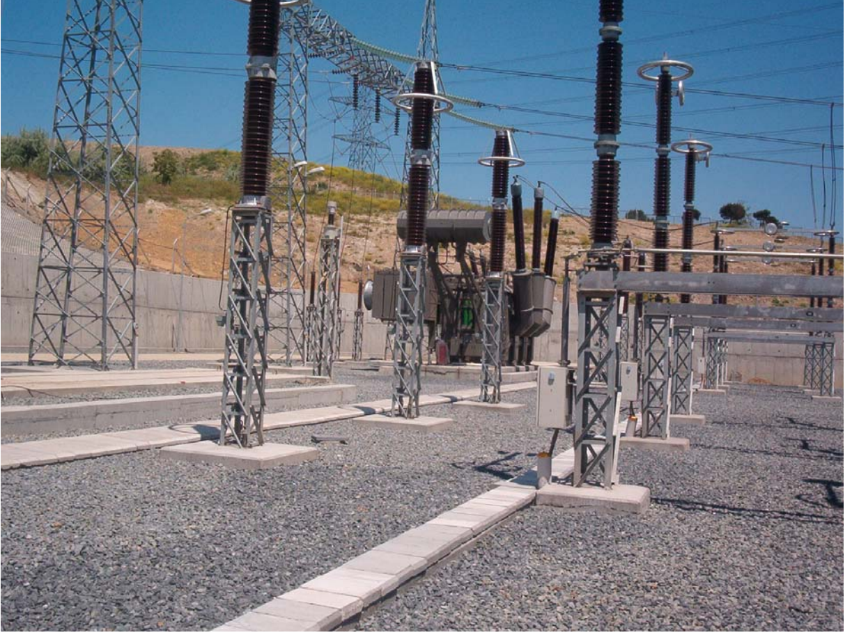
Şekil 4.2 380 kV Atışalanı açık şalt merkezi
