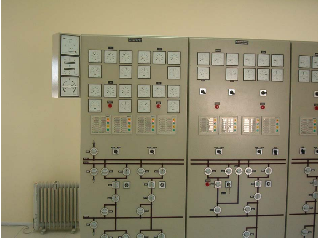
Şekil 4.4 380 kV kumanda panosu
