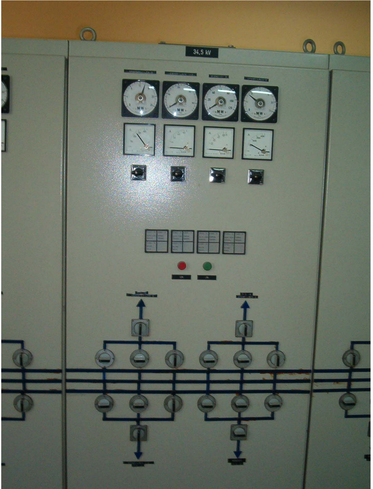
Şekil 4.5 34,5 kV kumanda panosu
