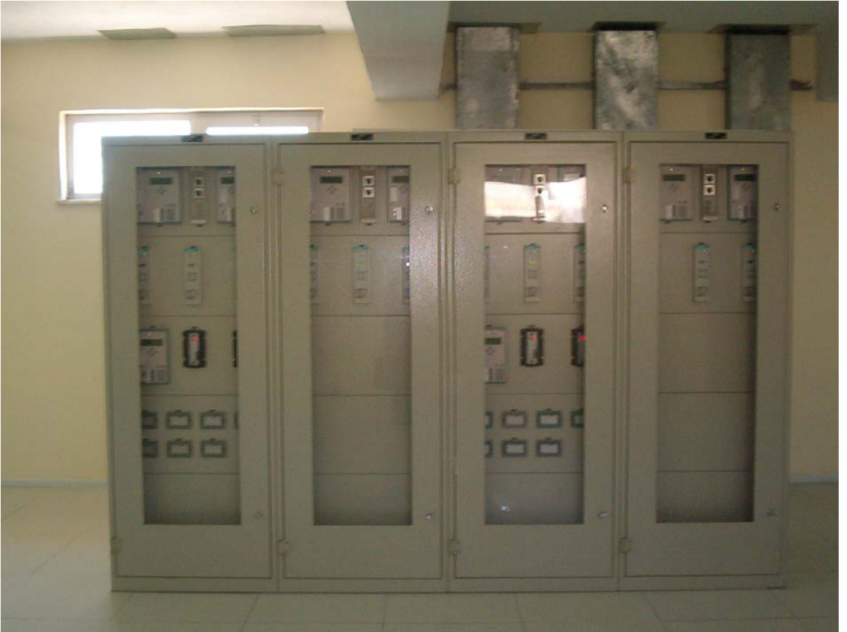
Şekil 4.6 380 kV röle panosu
