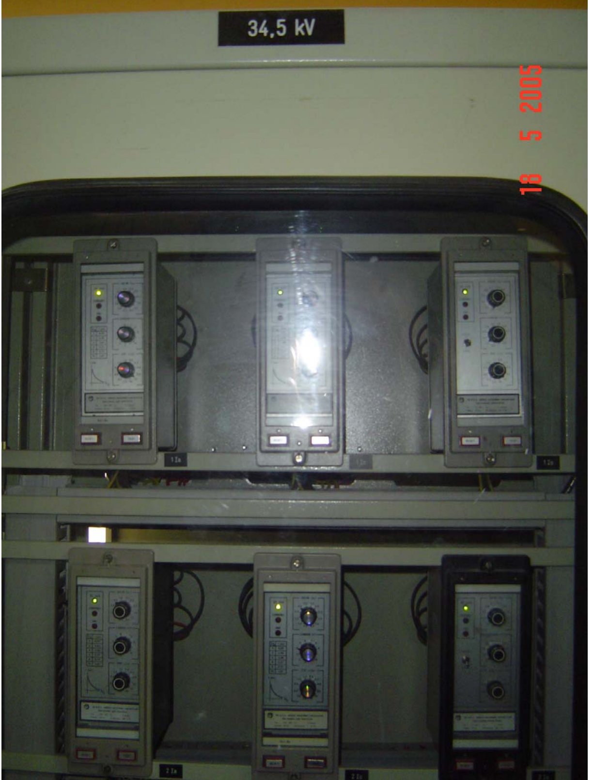
Şekil 4.8 34,5 kV röle panosu
