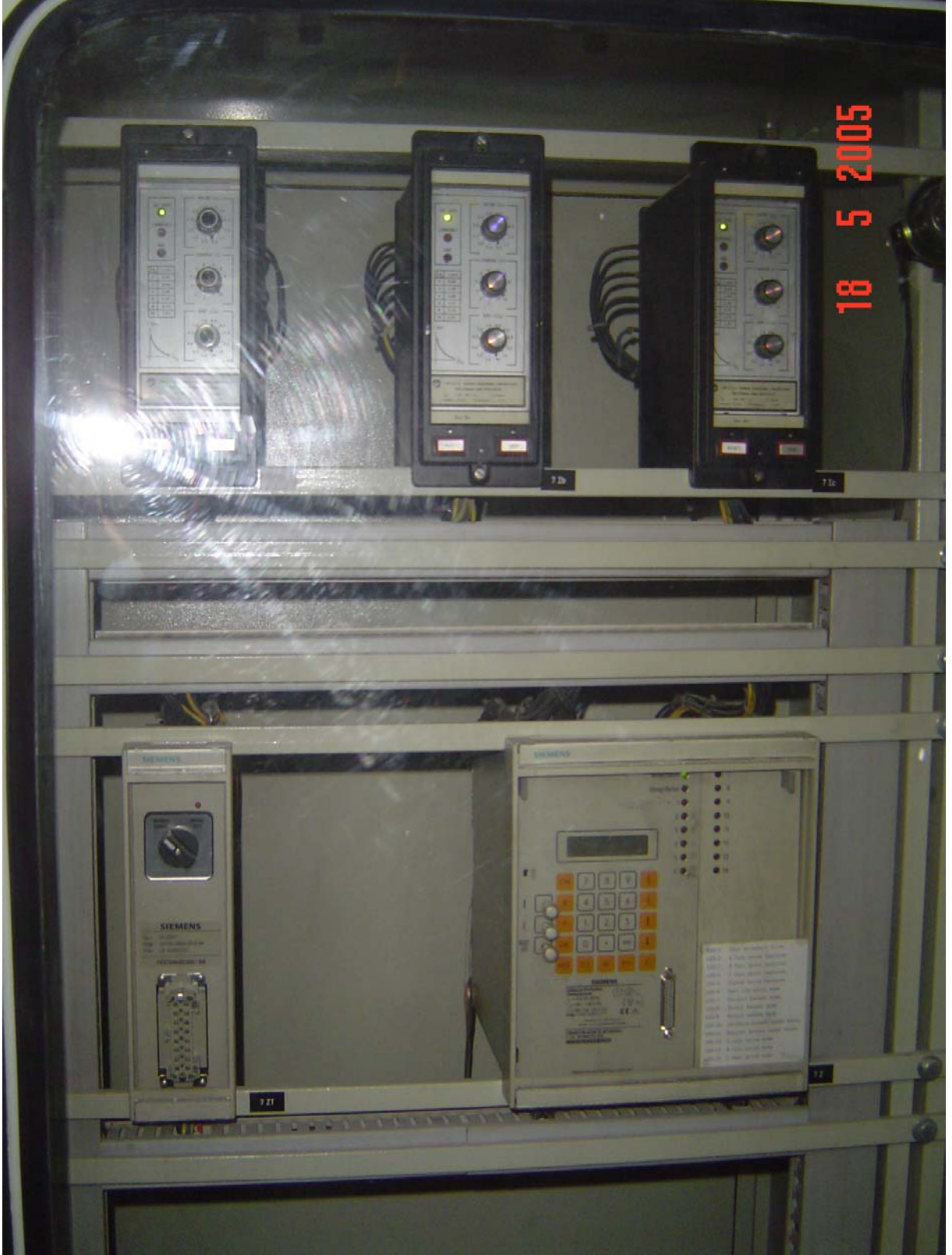
Şekil 4.7 154 kV röle panosu
