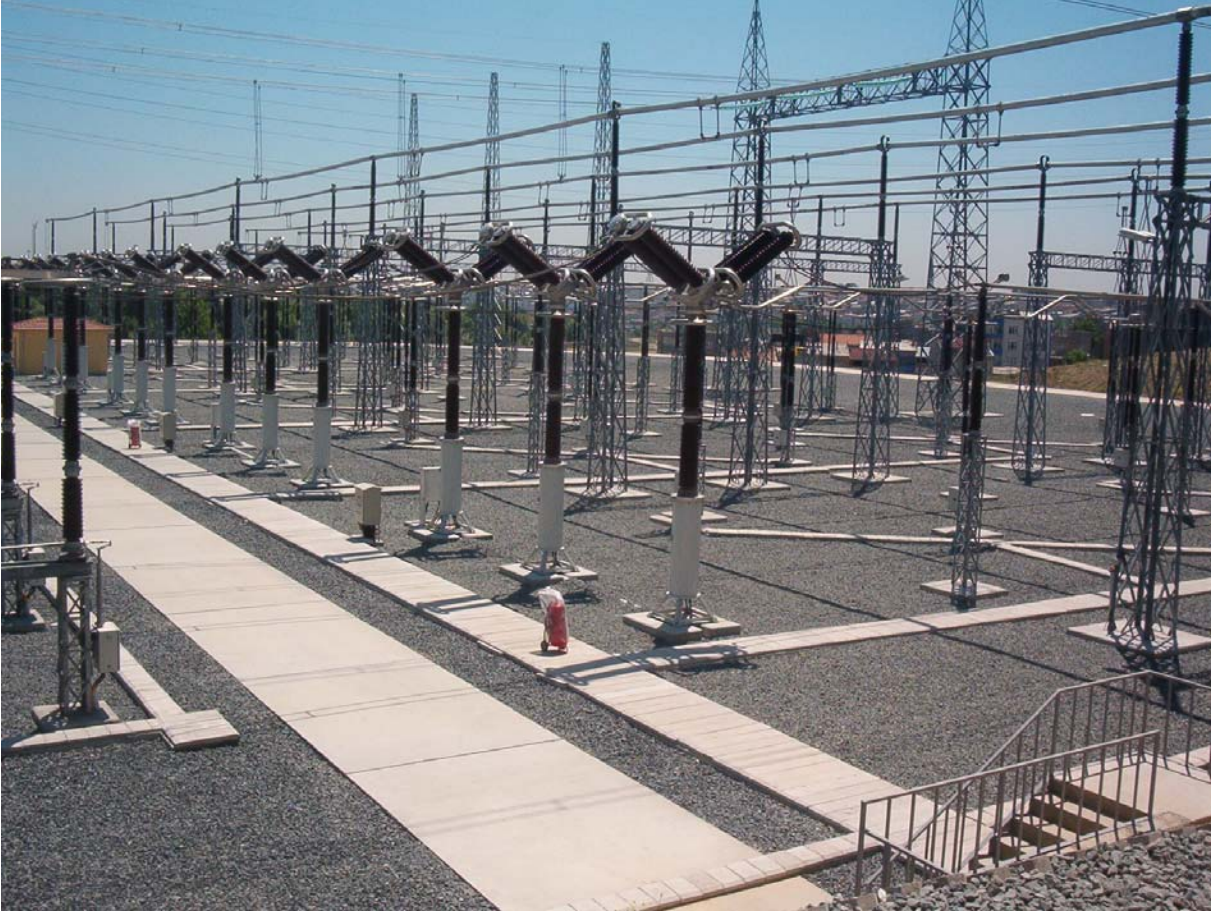
Şekil 4.3 380 kV Atışalanı açık şalt merkezi
