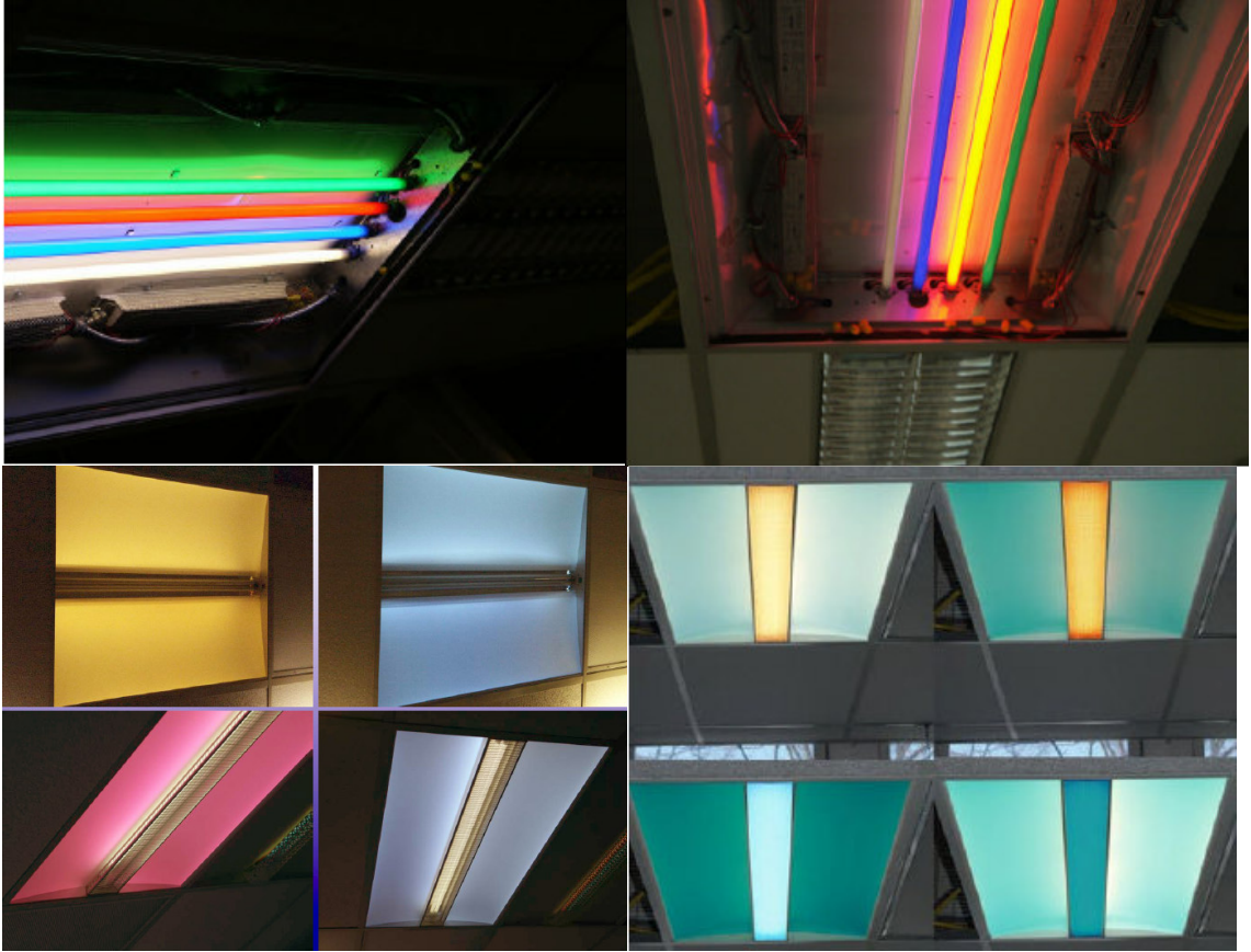
Şekil 8.21 Renk kontrolünde kullanılan armatürler
