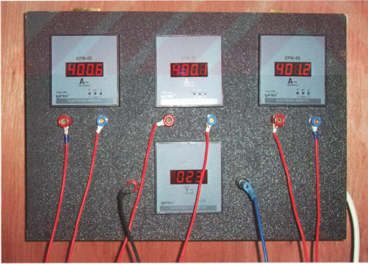
Şekil 4.4 Yüksek akım laboratuvarındaki ampermetreler.
