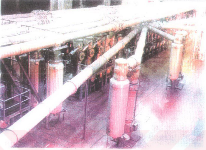
Şekil 12.4 BBC tarafından yapılan G.I.S. ( 550 kV )
