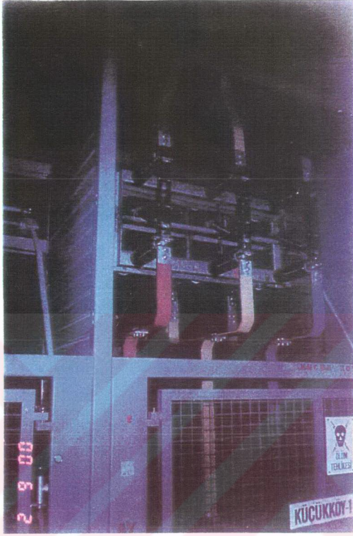
Şekil 11.14 Davutpaşa T.M. - 34,5 kV. Hücre Bara Ayırıcısı
