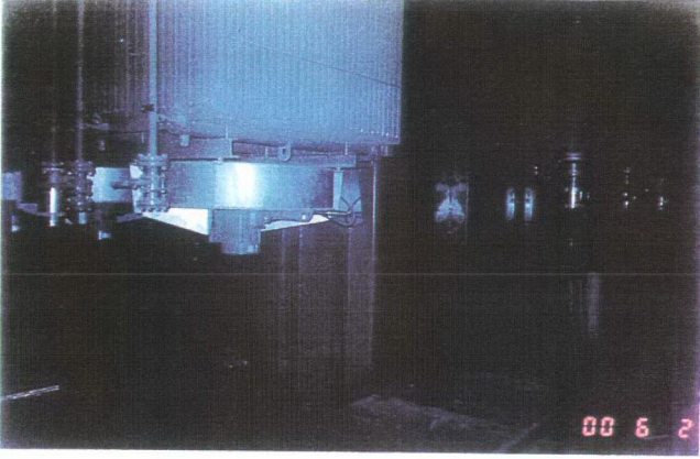
Şekil 11.5 Güç Trafosu 154 kV. Kablo Girişleri
