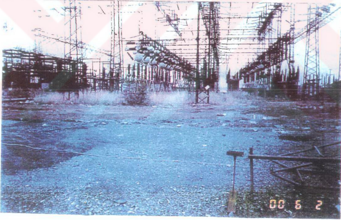
Şekil 11.2 154 / 34,5 kV. Yıldıztepe T.M. ( açık şalt ) Genel Görünüş
