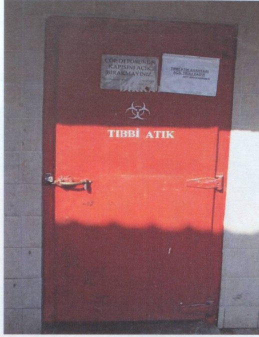
Şekil 15: Tıbbi Atık Deposu
