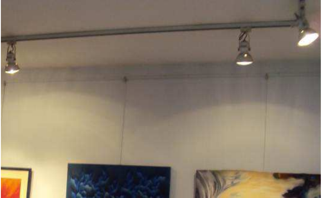
Şekil 3.39: T.C. Balıkesir Belediyesi Devrim Erbil Çağdaş Sanat Müzesi, Aydınlatma Sistemi
