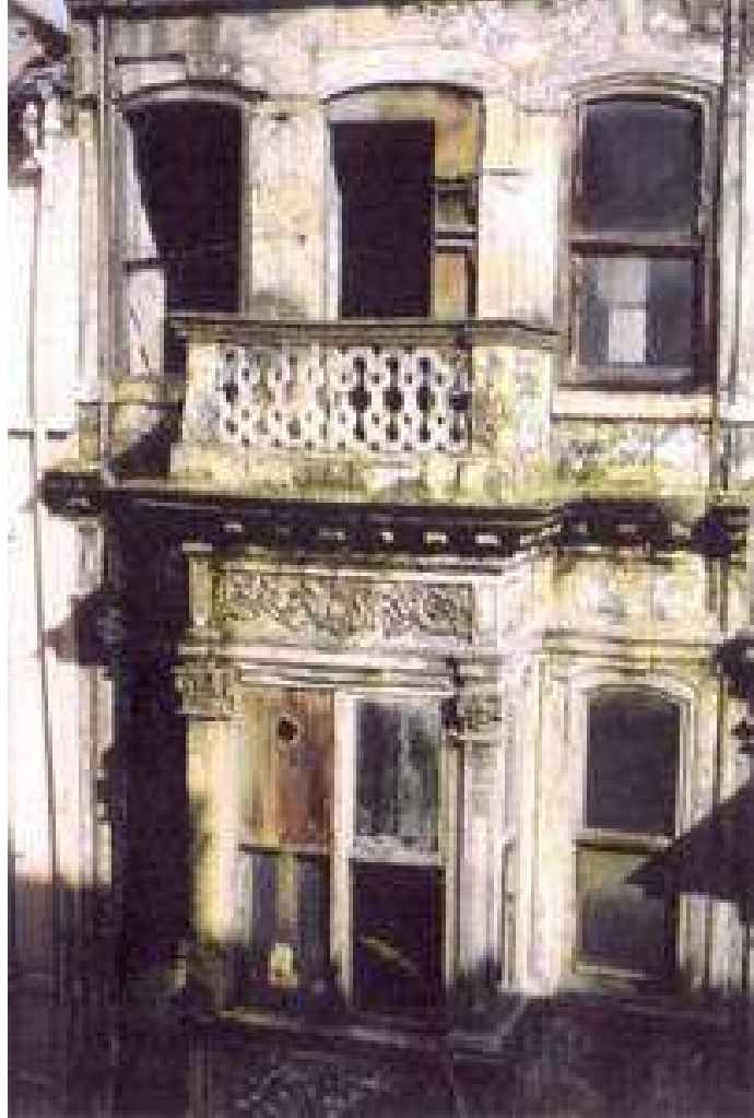
Şekil 3.45: Restorasyondan Önce Doğançay Müzesi Binası Cephe
