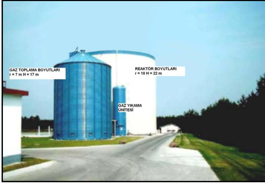
Şekil 5.16 Anaerobik Arıtma ve Biyogaz Ünitesi (Pehlivan E.,2009)
