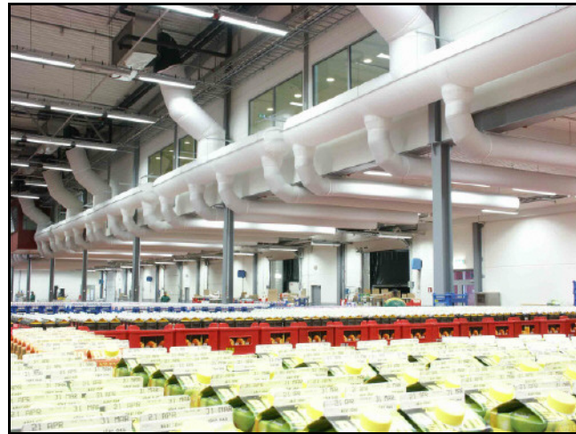
Şekil 5.1 Mezbahalarda Kullanılan Havalandırma Sistemi
