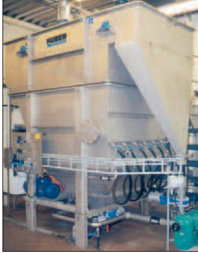
Şekil 4.1 Arıtmada Kullanılan DAF Ünitesi
