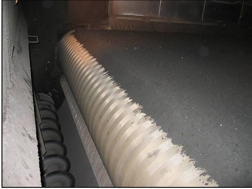
Şekil 5.18 Arıtma Çamurunun Kurutma İşleminde Kullanılan Konveyör
