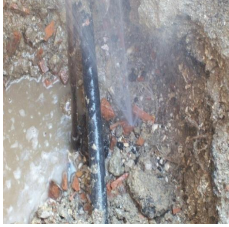
Şekil 5.33 Şube yolu bağlantısında bulunan su kaçağı
