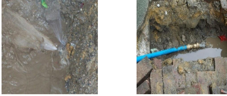
Şekil 5.32 Dördüncü su kaçağının tespiti ve onarımı
