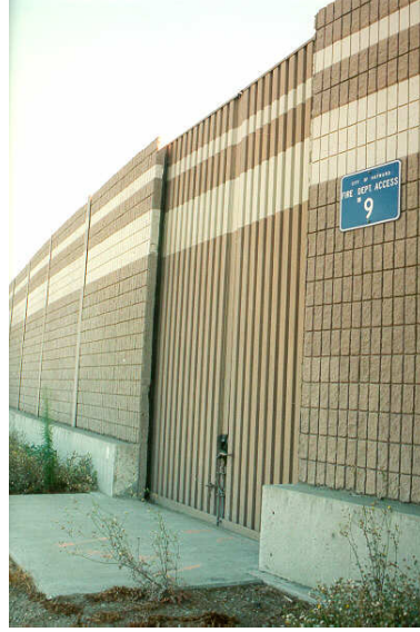
Şekil 5.10 Gürültü perdesi acil çıkış yapısı görünümü (FHWA, 2007)
