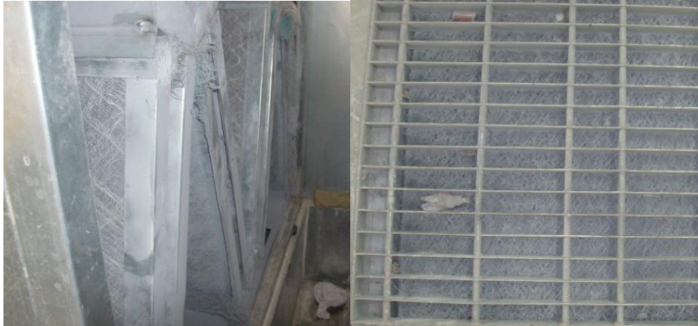
Şekil 3.12. Boya kabini filtrelerinden görünüş
