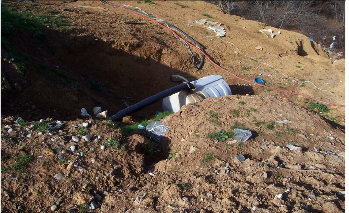
Sızıntı suyu toplama tankı
