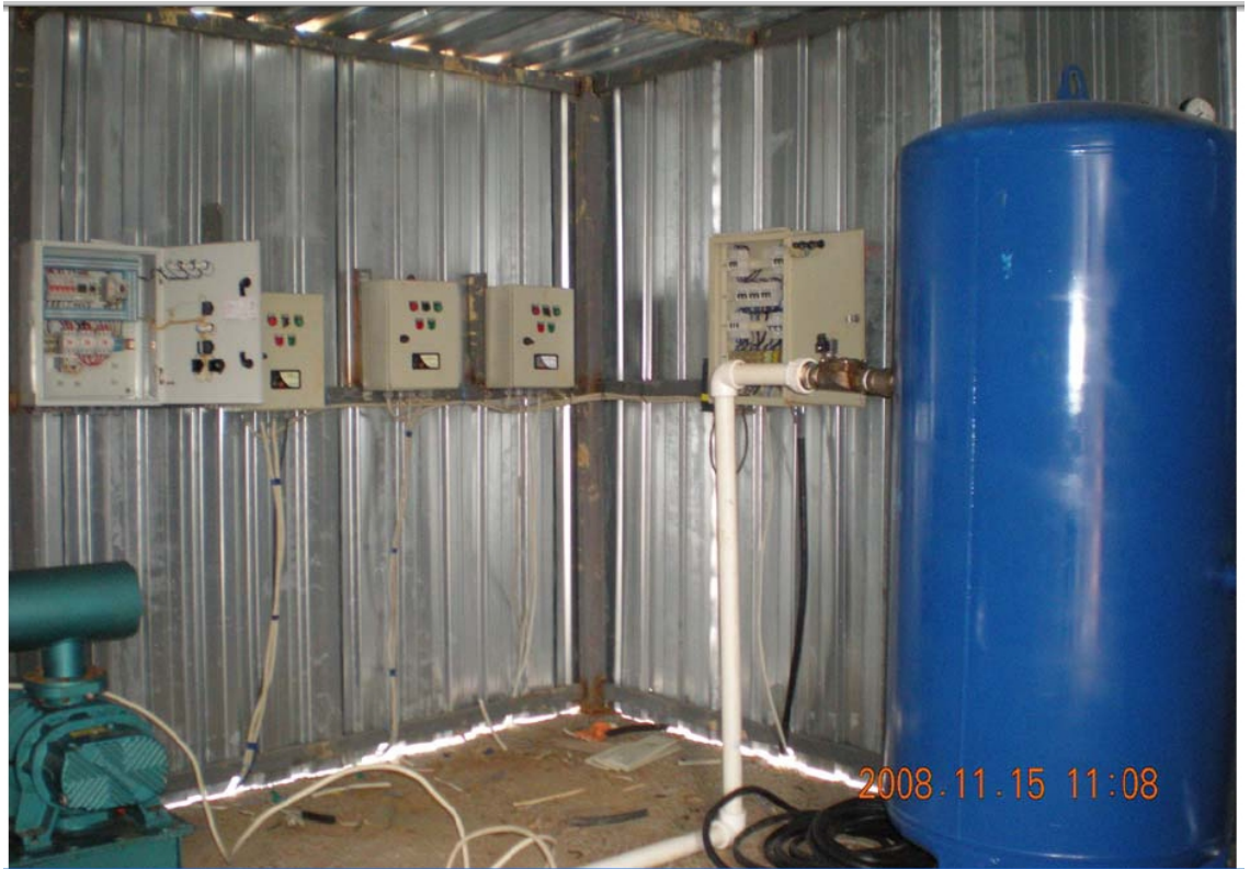
Kompresör, blower ve pompa kontrol odası
