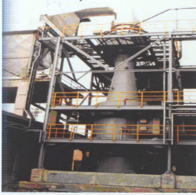
Şekil 4.16 Ventüri tipi ıslak arıtıcının dışarıdan görünümü.
