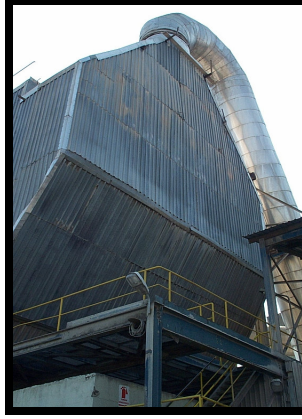
Şekil 6.5 Elektrofiltreler Akçansa A.Ş.
