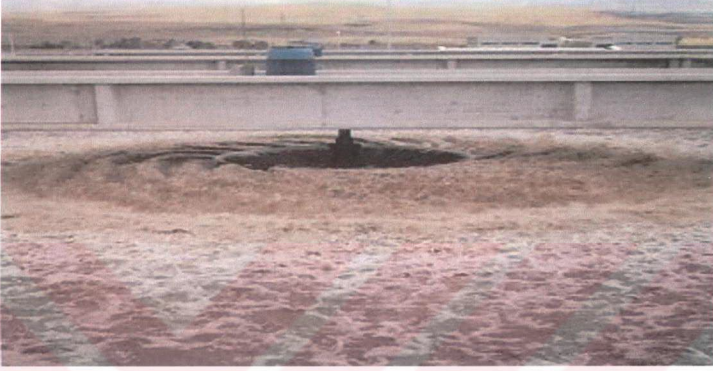
Şekil 5.6 ASKİ Arıtma Tesisi Havalandırma Havuzundan Bir Görünüş
