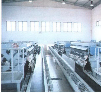
Şekil 5.9 ASKİ Arıtma Tesisi Mekanik Susuzlaştırma Ünitesi (Bant Filtre) Görünüşü
