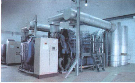
Şekil 5.8 ASKİ Arıtma Tesisi Biyogaz Güç İstasyonunun Görünüşü
