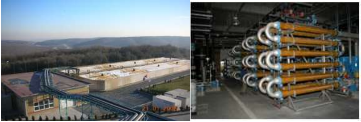
Şekil 6.3 Sızıntı suyu arıtma tesisi
