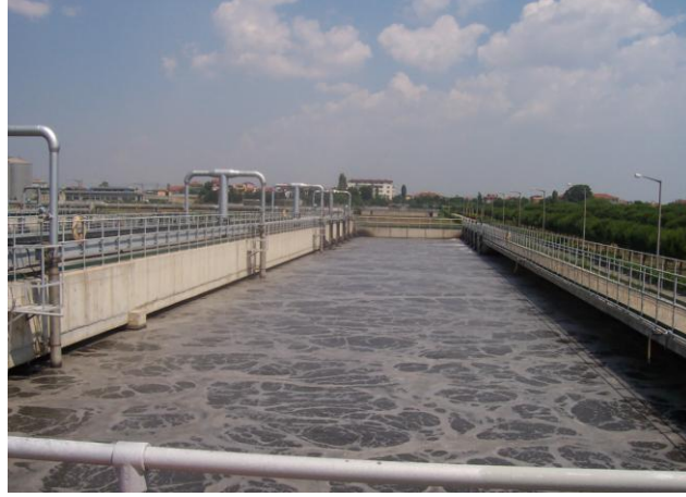
Şekil 5.6 Biyolojik arıtma, havandırma havuzu
