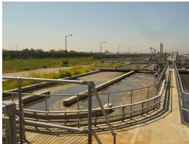
Şekil 5.7 İleri biyolojik arıtma anaerobik biyofosfor havuzu
