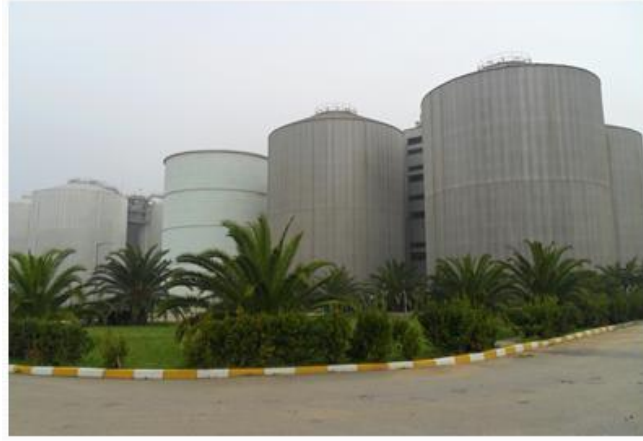
Şekil 5.11 Anaerobik çamur çürütme ünitesi
