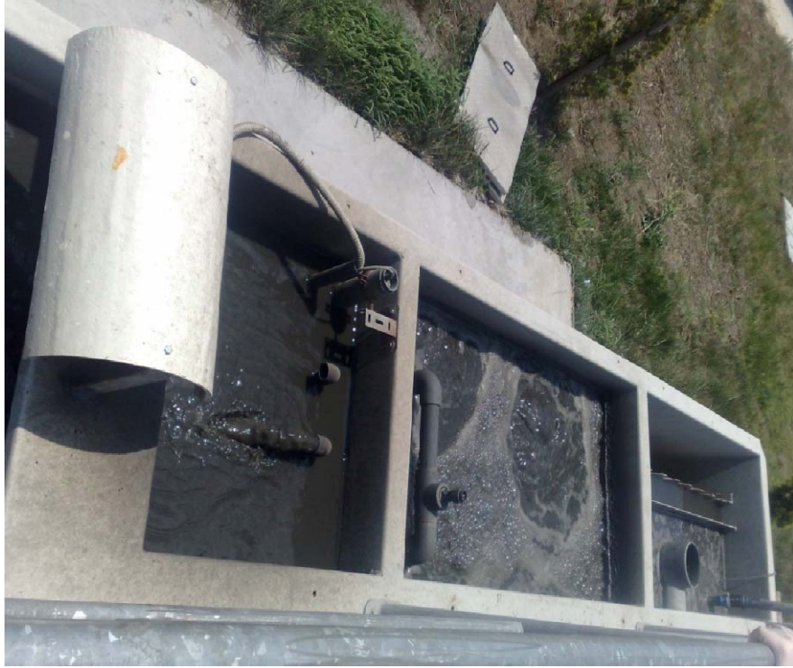
Şekil 5.6 Anoksik1, aerobik1 ve son çöktürme havuzlarının üstten görünüşü
