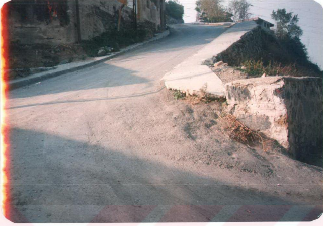
Fotoğraf 4.27: Alibeyköy vadisinde eğimin yapılaşmaya elverişli olması nedeniyle dik yollara sıklıkla rastlanılmaktadır. Asfalt yollara yağın yağış çabucak kanallara ulaştığından hemen kurumaktadır.
