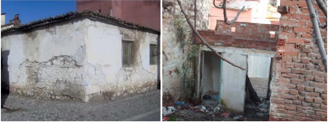
Şekil 4.63 ve 4.64 297 no'lu yapı adasında yeralan viran yapılar
