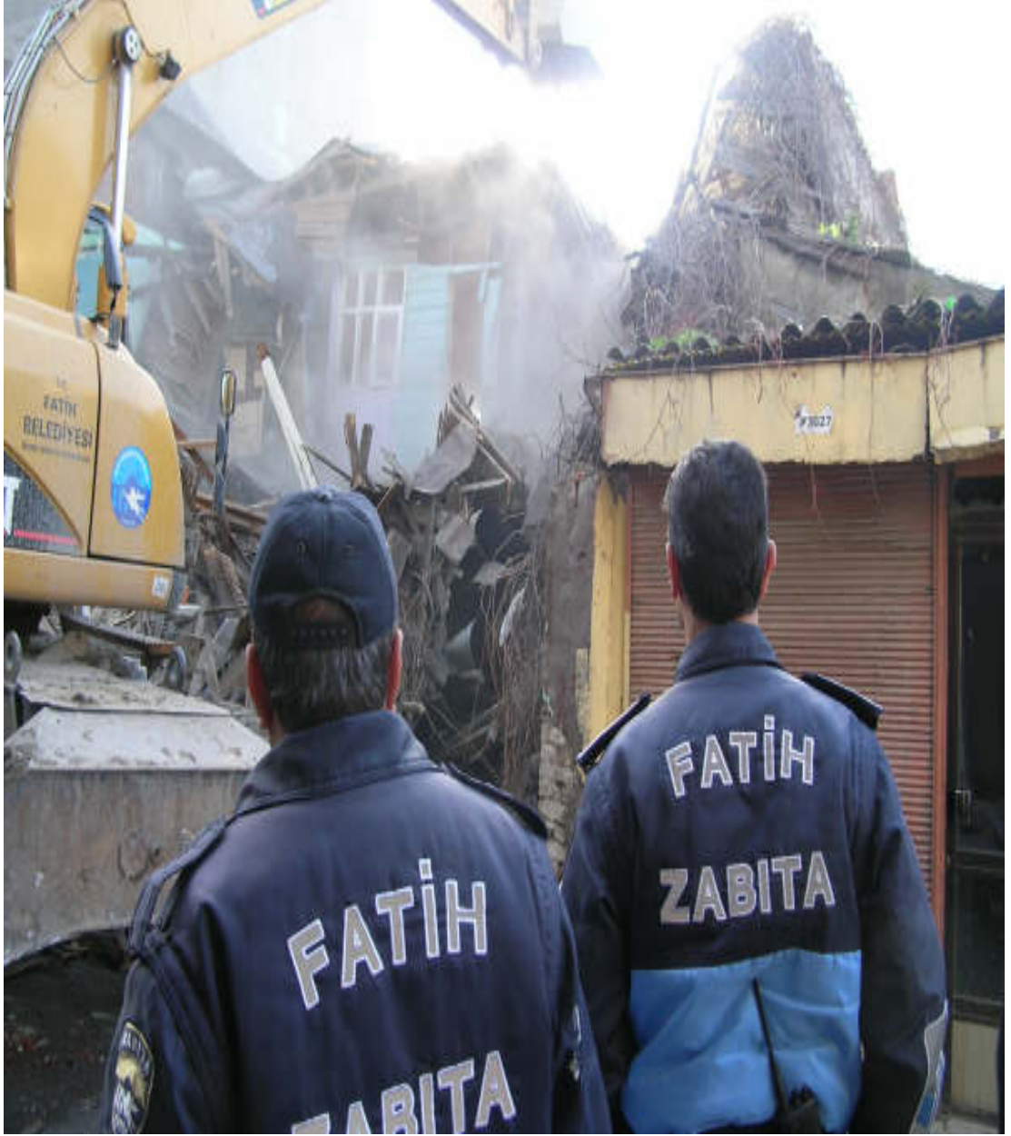
Şekil 2. Fatih Belediyesi Ekiplerince Sulukule’de yıkılan bir ev. (25.12.2008)
