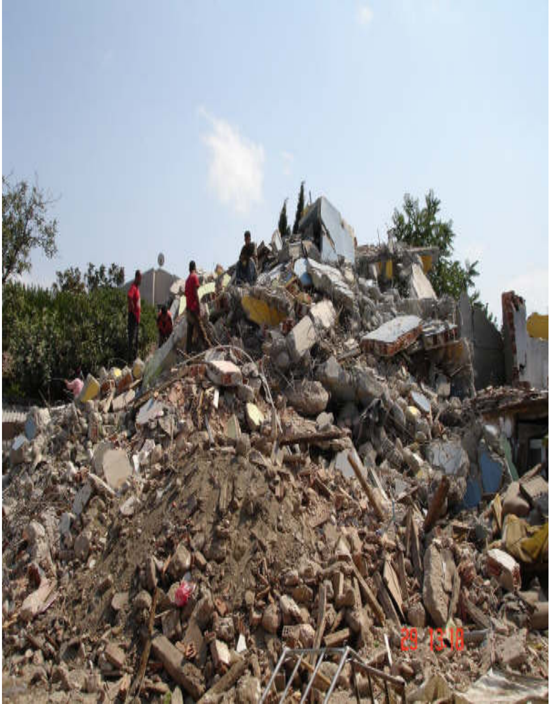
Şekil 4. Sulukule’de yıkılmış bir ev. Romanlar yıkılan evin enkazından çıkan demirleri topluyorlar. (15.08.2008)
