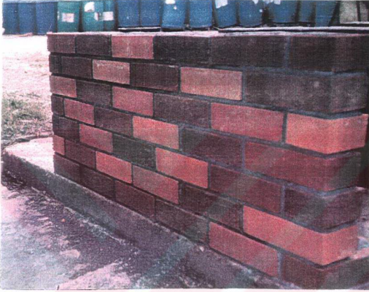
Şekil 5.4 Silikon uygulaması yapılmış duvar (çiçeklenme yok)
