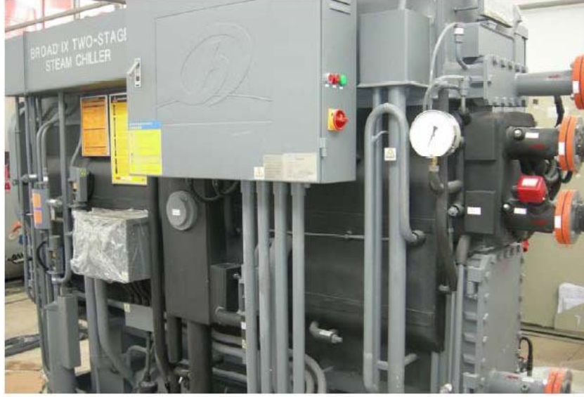
Şekil 6.3 Absorbsiyonlu soğutma sisteminde iki kademeli soğutucu
