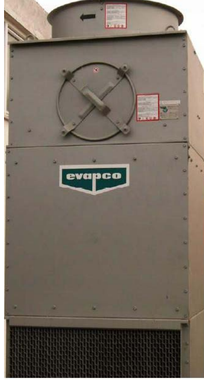
Şekil 6.2 Absorbsiyonlu soğutma sisteminde kullanılan soğutma kulesi
