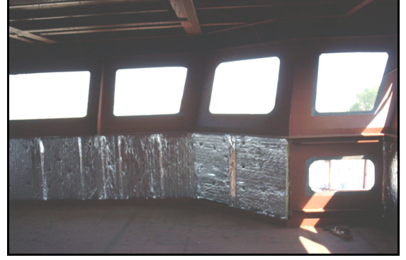
Şekil 4.30 Köprü üstü yangın izolasyonu.
