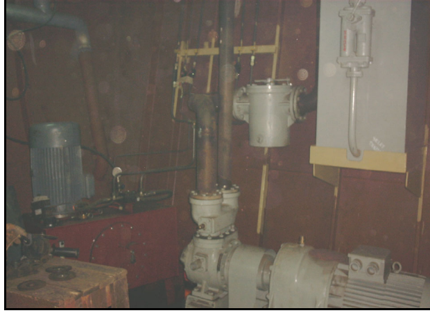
Şekil 4.15 Kıç ırgat güç hidroliği sistemi.
