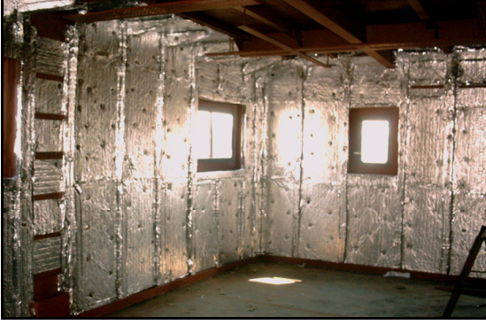
Şekil 4.29 Üst bina yangın izolasyonu.
