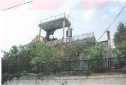
Şekil 5.6. “Bakım yapılmamış” bina iken, “yıkık” hale gelen binalara örnek
