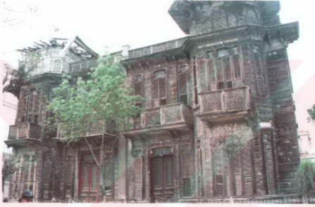
Şekil 4. 9. Bakım yapılmamış olarak nitelenen binalara örnek
