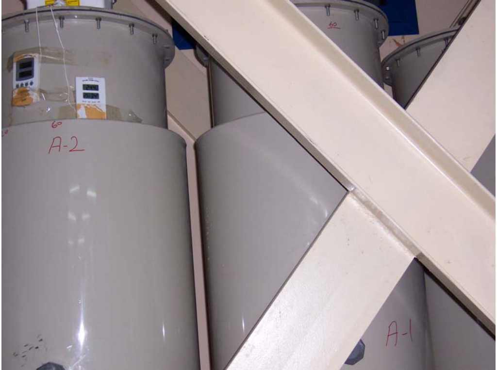
Aerobik reaktörlerin işletme aşamasına ait görünüş
