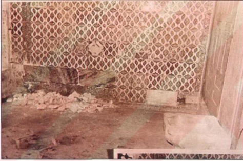
Resim 3.4.13.9 Cariyeler Dairesi 2. oda çini onarımı öncesi görüntüsü (TSDA, 55/49-a)
