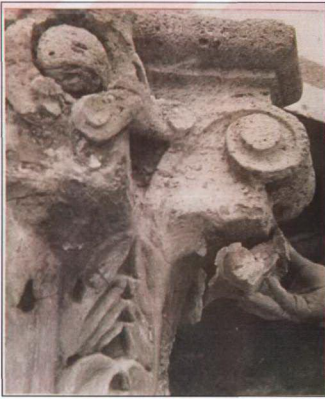
Resim 3.1.4.6 Adalet Kulesi dış cephesinde sütun başlarındaki bozulmalar (TSDA. TSM. No:55/63)
