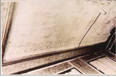
Resim 3.4.12.5 III. Selim Dua Odası merdiven başı tavanı onarım öncesi görünüşü (TSDA. 55/49-a )
