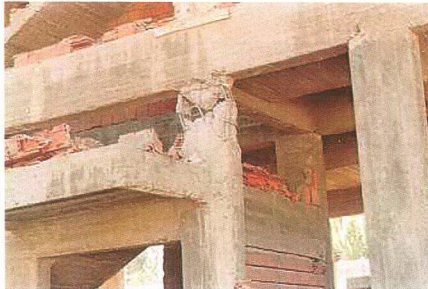
Şekil 5.55 Kısık kolon oluşumuna bağlı hasarlar [29]
