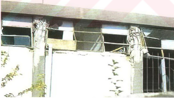
Şekil 5.45 Düzce Lisesi: Kısa kolon etkisi nedeniyle, bant pencerelerin iki yanındaki kolonlarda hasarlar (Çelik vd., 2000)
