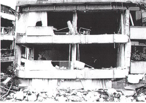
Şekil 5.63 İzmit depremi - Zayıf kolon-güçlü kiriş oluşumuna bağlı olarak oluşan hasar (Bruneau, 2002)
