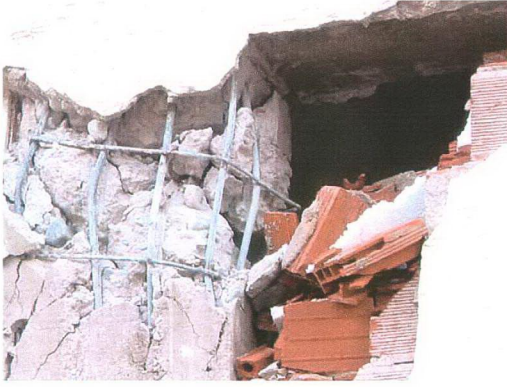
Şekil 5.74 Bingöl Karaelmas İlköğretim Okulu – Kolonda mafsallaşmaya bağlı hasar oluşumu (Kaplan vd., 2003)
