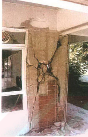
Şekil 5.66 Düşük kaliteli beton [34]
