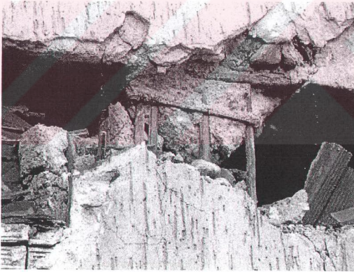
Şekil 5.73 Bingöl Mehmet Akif İlköğretim Okulu - Kolonda mafsallaşmaya bağlı hasar oluşumu (Kaplan vd., 2003)
