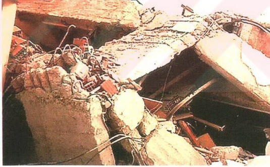
Şekil 5.69 Marmara Depremi – Kalitesiz beton nedeniyle beton-çelik birleşiminin yetersiz olması, buna bağlı ağır hasar [36]
