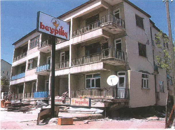
Şekil 5.32 Bingöl depreminde zemin kat işyeri olarak kullanılan yapıda yumuşak kat etkisine bağlı yıkım (Kaplan, vd., 2003)
