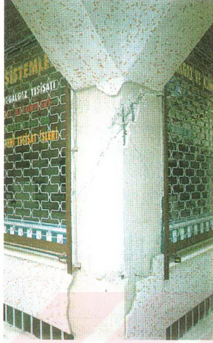
Şekil 5.42 Konsol ucunda kolonlu yapıda köşe kolonda çatlak (Çelik vd., 2000)
