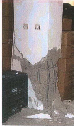
Şekil 5.52 Zemin katı işyeri olan bir yapının asma katı taşıyan kolonu üzerinde kısa kolon hasarı (Kaplan vd., 2003)
