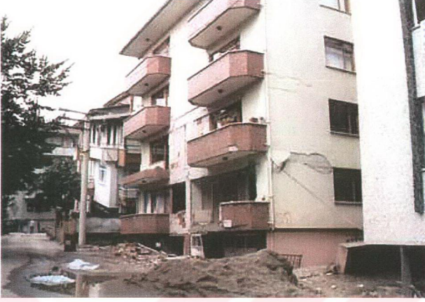
Şekil 5.14 Adapazarı bölgesinde sıvılaşmaya bağlı hasar oluşumu: zemin içine batan yapı [18]
