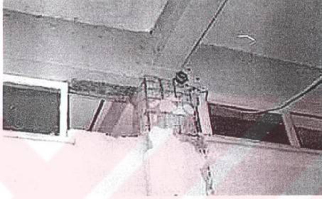
Şekil 5.48 Bant pencerelerin yanında yer alan kolonlar üzerinde kısa kolon oluşumuna bağlı hasarlar (Çelik, 1999)
