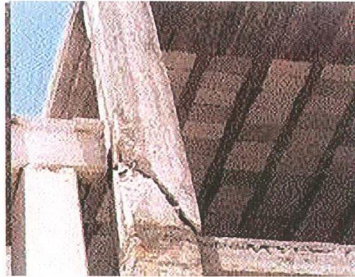
Şekil 5.60 Adana Ceyhan - İki komşu yapının çarpışmasına bağlı olarak kolonda ortaya çıkan kayma çatlağı [32]
