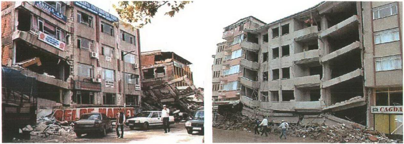
Şekil 5.35 Adapazarı'nda zemin katı ticari amaçla düzenlenmiş yapıların yumuşak kat etkisine bağlı çökmesi [20] [21]
