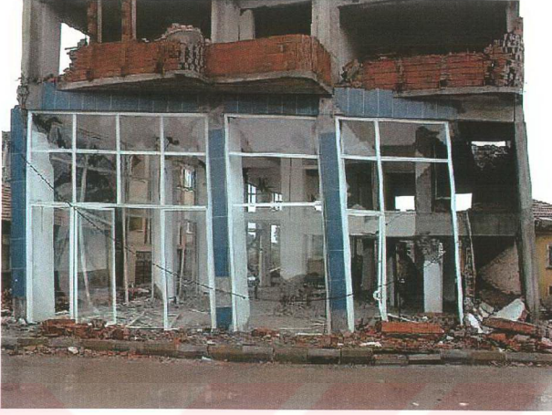
Şekil 5.36 İzmit'te zemin katı diğer katlarına oranla daha yüksek ve geniş vitrinlerle düzenlenmiş yapıda yumuşak kat etkisine bağlı hasarlar [22]
