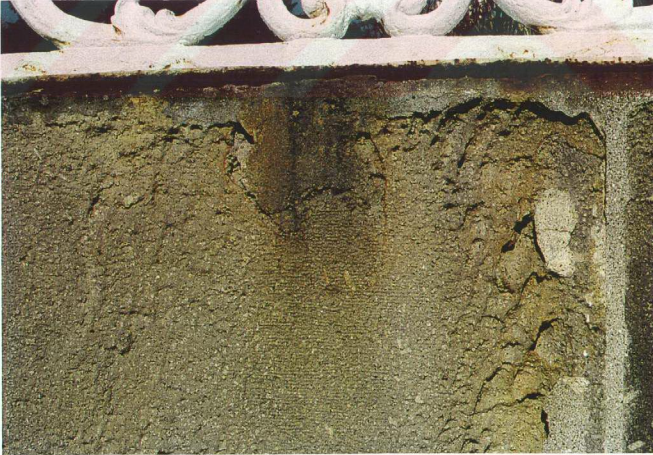
Şekil 4.27. Rıhtımdaki demir parmaklıklardaki korozyon ve taşdaki çatlaklar.
