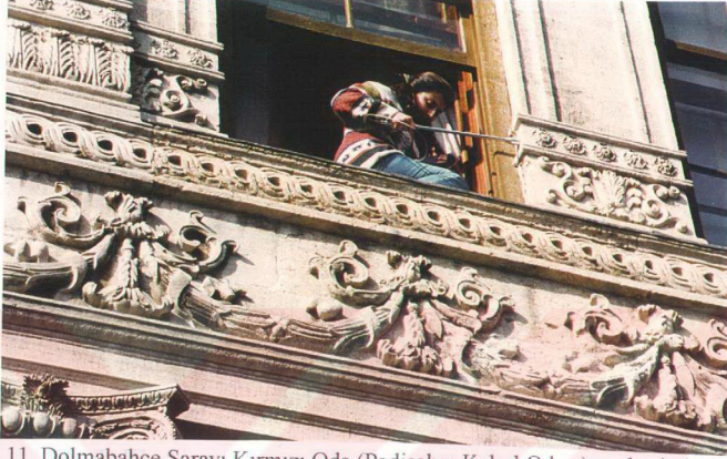
Şekil 4.11. Dolmabahçe Sarayı Kırmızı Oda (Padişahın Kabul Odası) cephesinde duvar dış yüzeyinde protometri aleti ile yapılan duvar nem tespiti.
