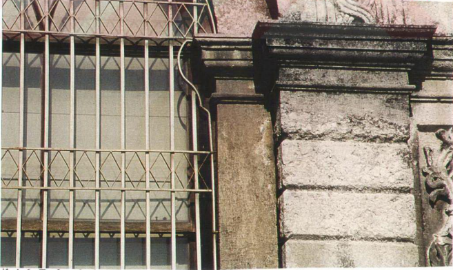
Şekil 4.6. Dolmabahçe Sarayı güney cephesindeki taş yapı malzemesinde ısıl genleşmesi sonucunda olan yüzey kopması görülmektedir.
