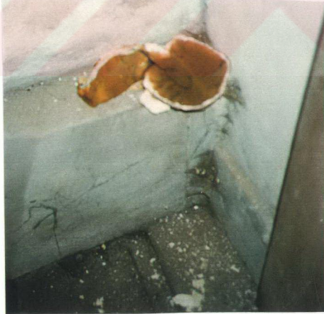
Şekil 4.33. Cariyeler Dairesi bodrum katında su-nem faktörlerin etkisiyle ortaya çıkan biyolojik bozulma ve aşırı gelişmiş sıva mantarı görülmektedir.
