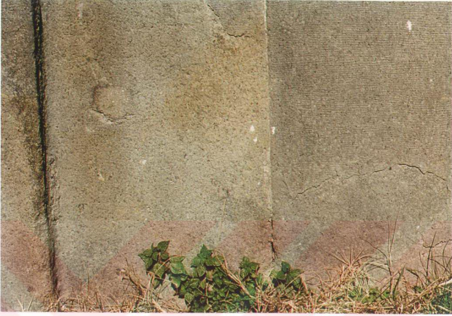
Şekil 4.37. Dolmabahçe Sarayı cephelerinde taş yapı malzemelerinde bitkilerin kökleri tahribat yaratabilmektedir.
