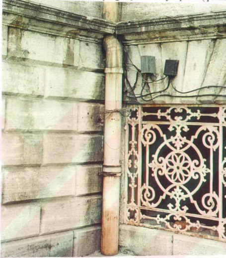
Şekil 4.10. Selamlık bölümü deniz cephesinde yağmur iniş borusundaki akıntılardan dolayı yağmur suyu, taş yüzeylerinden içeri girebilmektedir.
