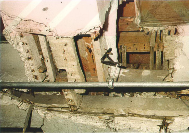
Şekil 4.18. Muayede Salonu bodrum katındaki taşıyıcı ahşap konstrüksiyondaki çürümeler görülmektedir.
