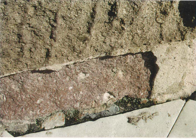
Şekil 4.4. Dolmabahçe Sarayı rıhtım babalarındaki bozulmuş olan taşın çimento bağlayıcı harçla yapılmış olan onarım sonrasında taş yüzeyinin ve sıvanın koparak düşmüş durumu görülmektedir.
