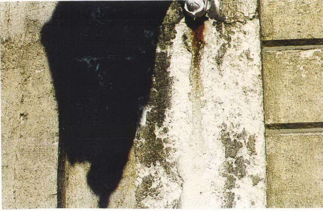
Şekil 4.28. Hazine Kapısı girişindeki duvardaki döküm demir aydınlatma lambasının kaidesindeki pas ve taş yüzeyindeki çatlaklar.
