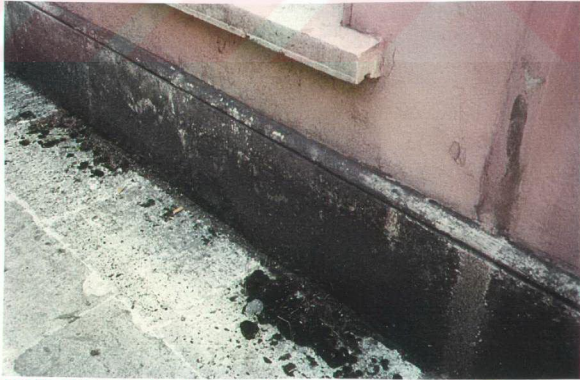
Şekil 4.9. Cariyeler Dairesi'nde subasman seviyesindeki kum taşlarında, sıcaklık farklılıkları ve nem etkisiyle oluşan yosunlaşmanın tahribatı görülmektedir.
