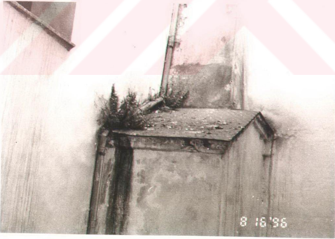
Şekil 4.38. Cariyeler Dairesi'nin bir iç avlusunda yağmur iniş borusundaki su sızıntısı nedeniyle oluşmuş olan yabancı bitkiler görülmektedir.
