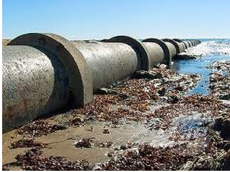
Şekil 4.6 Otel atıklarının denize tahliyesi
