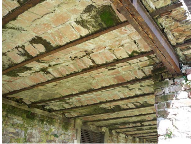
Şekil 2.4 Kagir yapıda kullanılan metal elemanlarda paslanma, Yetimhane, Büyükkada, İstanbul
