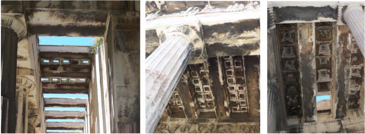
Şekil 3.34 Blok taş kiriş ile teşkil edilen döşemelerde meydana gelen hasarlar, Akropol, Yunanistan
