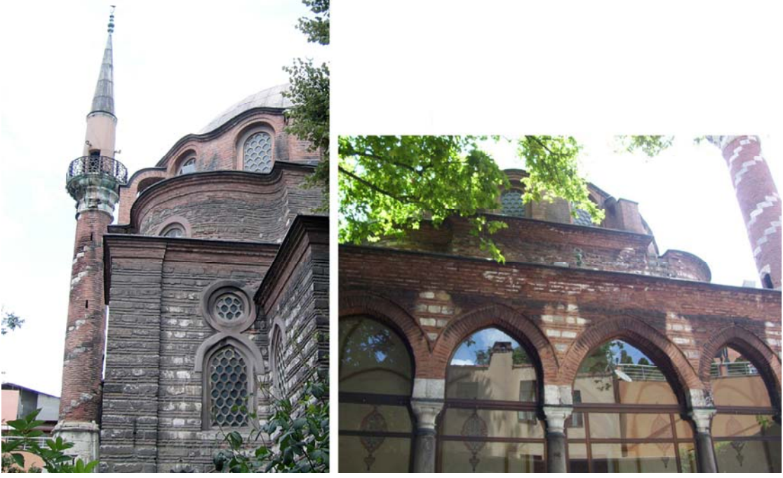
Şekil 2.12 Çevre kirliliği nedeniyle yüzey kararması ve malzeme yapısının bozulması, Zeynep Sultan Cami, İstanbul
