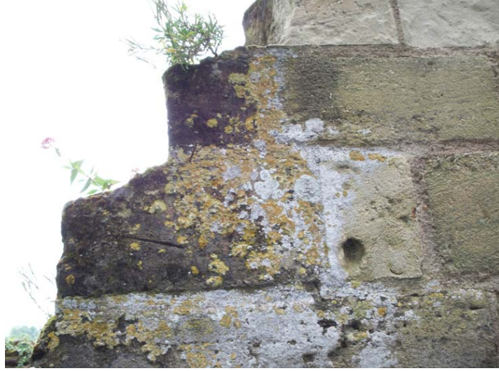
Şekil 2.8 Duvar yüzeyinde mantar oluşumu, Val de Loire, Fransa
