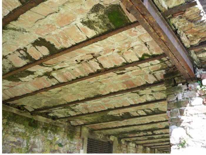
Şekil 3.36 Volta döşeme hasarı, Yetimhane, Büyükkada, İstanbul
