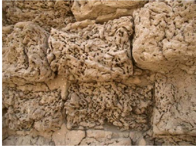
Şekil 2.7 Kerpiç malzemedeki termit hasarı, Abydos, Mısır (Fotoğraf: Görün Arun)
