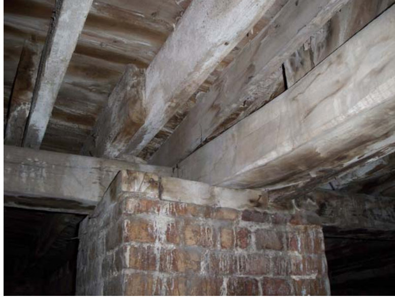
Şekil 2.5 Kagir yapıda ahşap elemanlarda bozulma, Yetimhane, Büyüka, İstanbul
