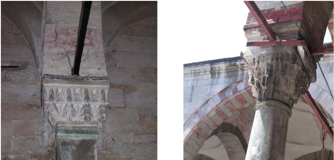
Şekil 3.2 Metal korozyonu nedeniyle meydana gelen sütun hasarları, Fatih Külliyesi, İstanbul
