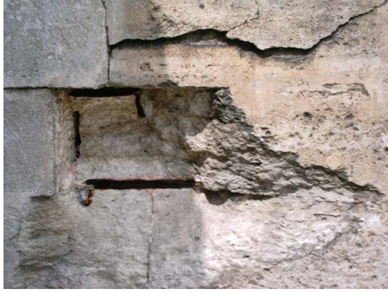
Şekil 2.3 Metal kenetlerdeki korozyon nedeniyle oluşan duvar hasarı, Edirnekapı Mihrimah Sultan Cami, İstanbul
