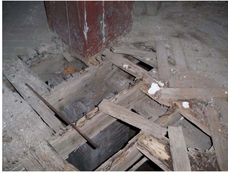
Şekil 3.35 Yığma kagir yapıda ahşap döşeme hasarı, Yetimhane, Büyükkada, İstanbul
