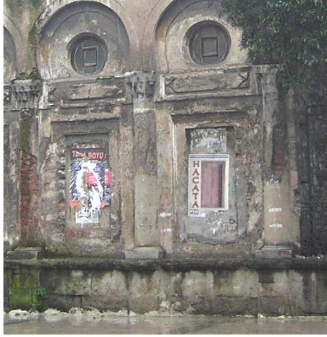
Şekil 2.14 Tarihi yapı cephesine yazı yazma ve afiş yapıştırma nedeniyle oluşan bozulmalar, Köprülü Medresesi, İstanbul
