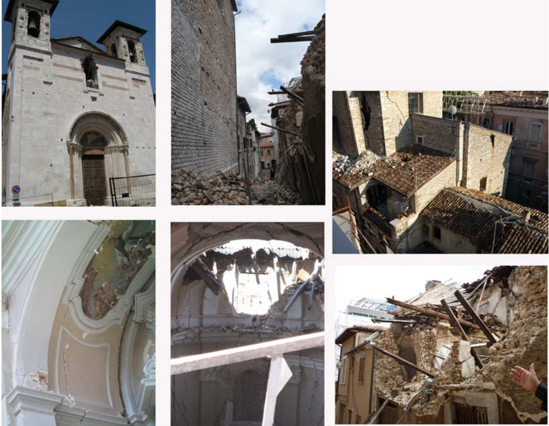
Şekil Ek7 1 San Marco Kilisesi hasar resimleri
