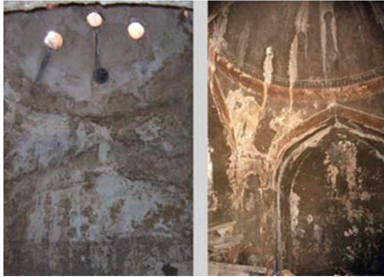
Şekil 2.1 Sudan kaynaklı bozulmalar, Ağa Hamamı, İstanbul
