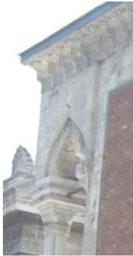
Şekil 5.62 Özgün olmayan revağın cephe duvarından yaptığı taşma (H. Meriç Uğraş, 2008).
