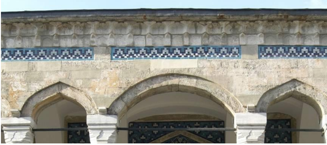
Şekil 5.89 Revak cephesindeki özgün olmayan çini bordür (H. Meriç Uğraş, 2006).
