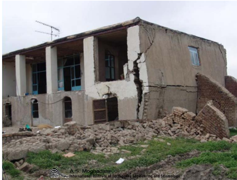
Şekil 4.10 Duvarda düzlemine dik yatay yükler etkisi ile yatay kırılma oluşumu- Silakhor (Moghadam 2006)
