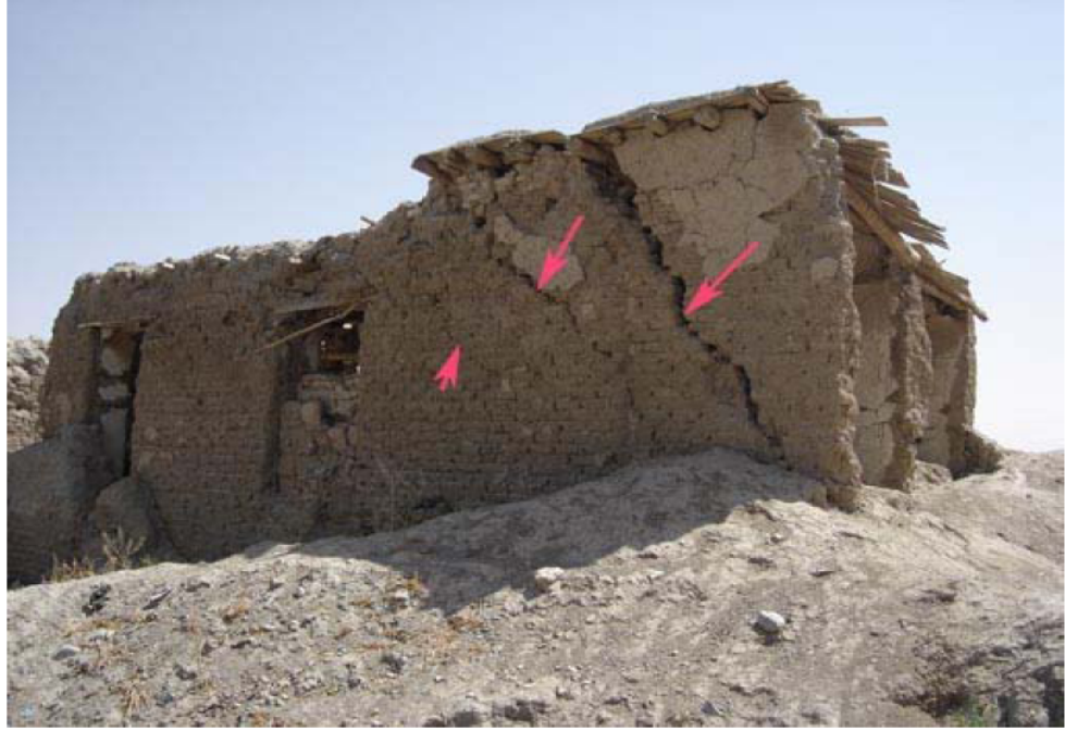
Şekil Ek 11.1 Duvar 4-K-1'e ait fotoğraflar
