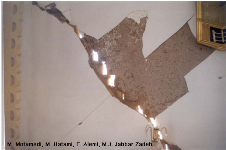
Şekil 4.17 Kerpiç duvarda oluşan diyagonal çatlaklar- Qazvin 2002 (IIEES arşivi)
