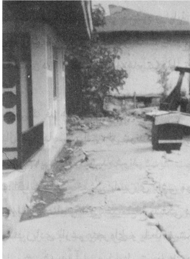
Şekil 4.37 Sıvılaşma sonucu yapının zemine batması- Manjil 1990 (Nateghi 2006)
