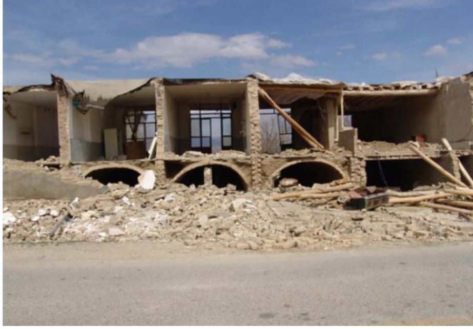
Şekil 4.35 Çatıdan ayrılan kirişlerin düşmesi sonucu oluşan hasarlar- Bam 2003 (Vaseghi 2003)
