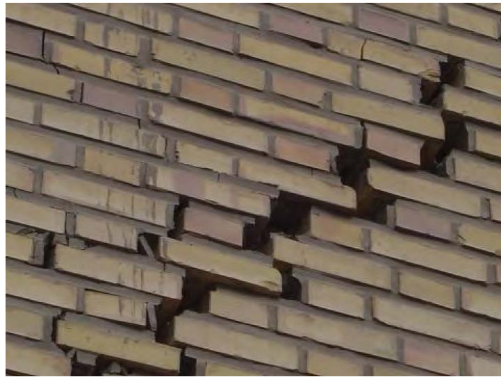
Şekil 4.15 Tuğla duvarda oluşan diyagonal çatlak- Bam 2003 (Eshghi 2003)
