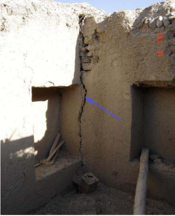
Şekil Ek 15.1 Duvar 10-K-1'e ait fotoğraflar
