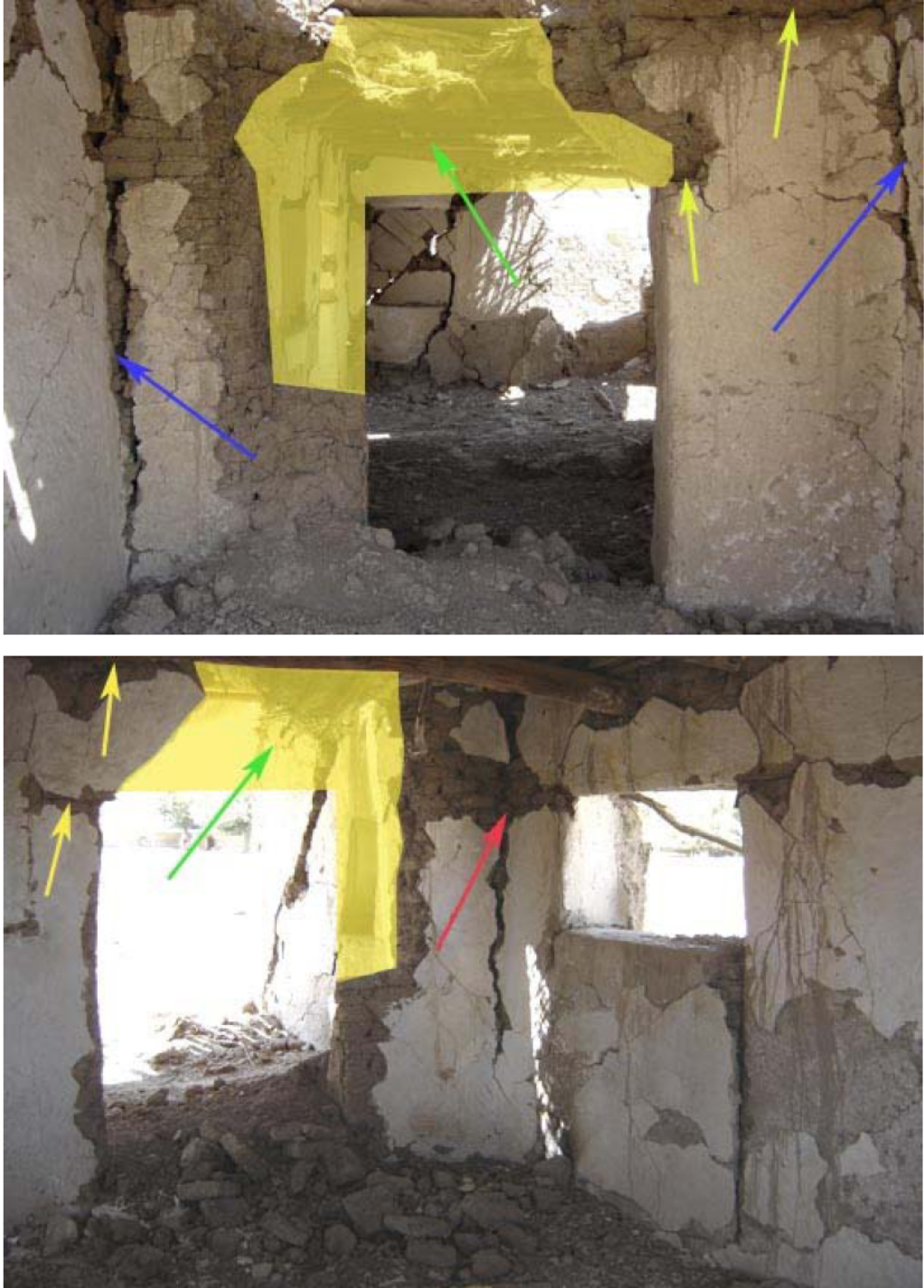
Şekil Ek 12.1 Duvar 4-K-4'e ait fotoğraflar
