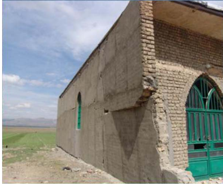
Şekil 4.9 Duvarda düzlemine dik yatay yükler etkisi ile yatay çatlak ve kırılma oluşumu- Silakhor (Moghadam 2006)
