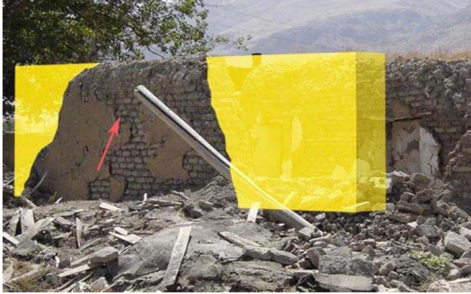
Şekil Ek 13.1 Duvar 8-K-1'e ait fotoğraflar
