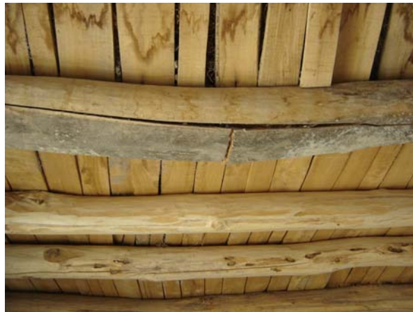
Şekil 6.6 Aşırı yük nedeni ile çatlamış bir kiriş örneği
