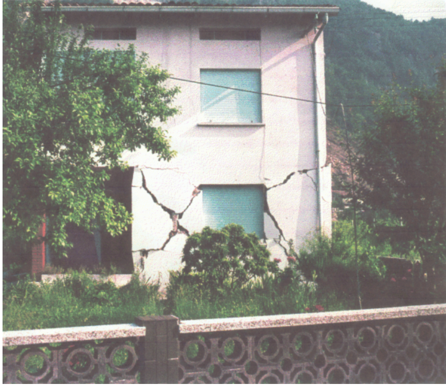
Şekil 4.16 Boşluklar arasında oluşan diyagonal çatlaklar- Friuli, Italy 1976 (Davidovich, 1991)
