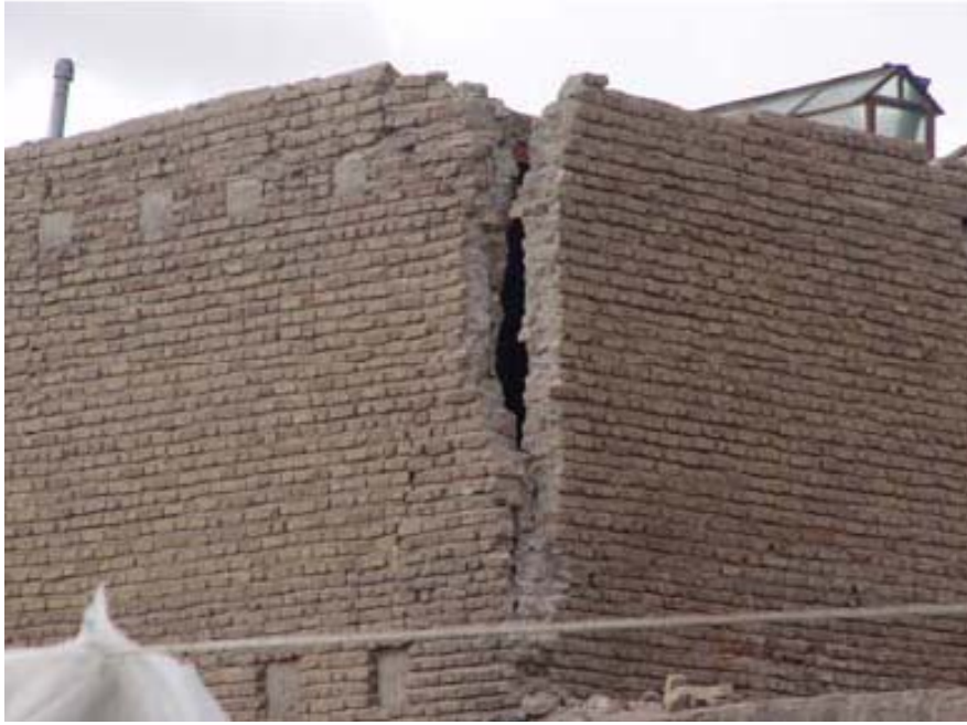
Şekil 4.25 Köşede iki yönde oluşan düşey çatlak- Broojerd (IIEES arşivi)
