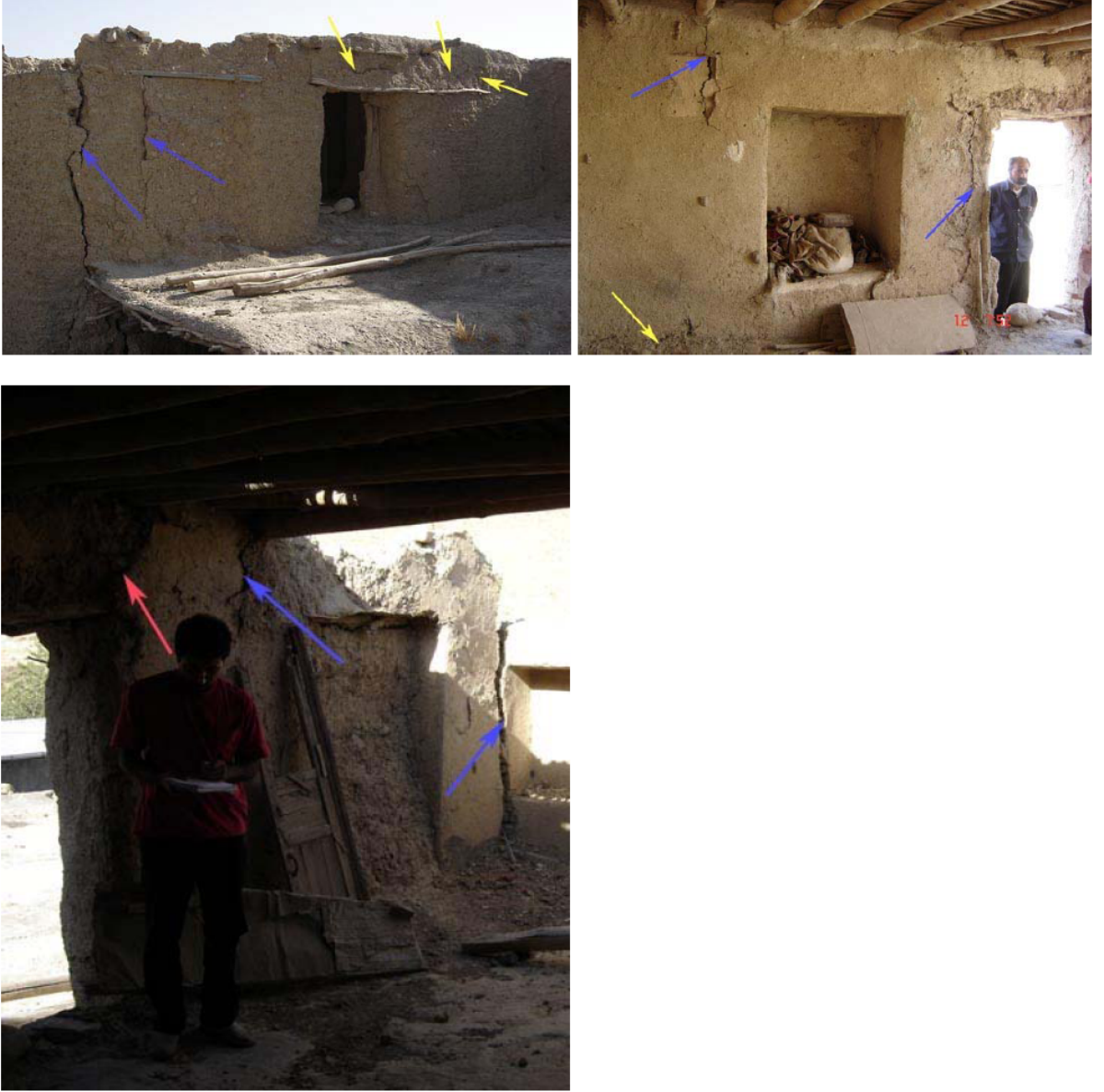
Şekil Ek 16.1 Duvar 10-K-8'e ait fotoğraflar
