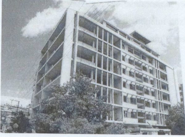
Şekil 5.1.2.3.1 Bossa Apartmanı'nın yıkım sürecinde strüktürünü gösteren bir fotoğraf (Adana KTVKKBK arşivi)
