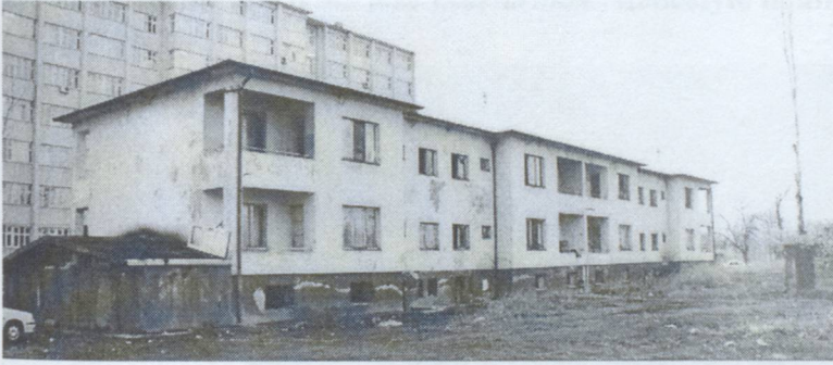
Şekil 3.1.2.3.3. Sümerbank yerleşkesinde dış usta evlerinin renk değişimi, bakımsızlık ve eklentilerle sıradanlaşan cepheleri (Asiliskender, B.,2002)
